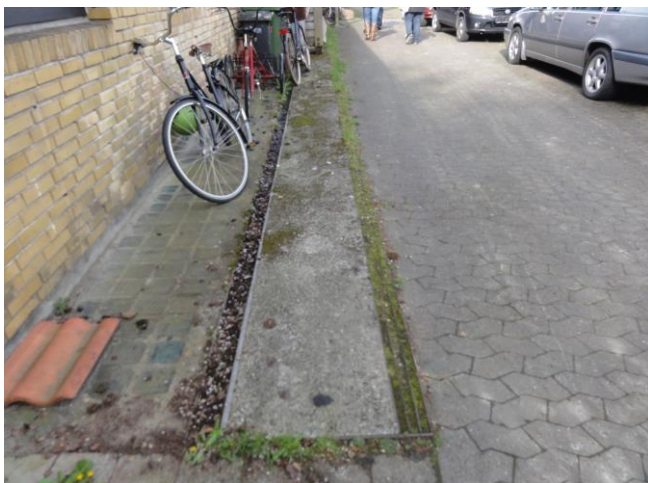
Foto nummer 4 Rende til opsamlingskar nord for bygningen
