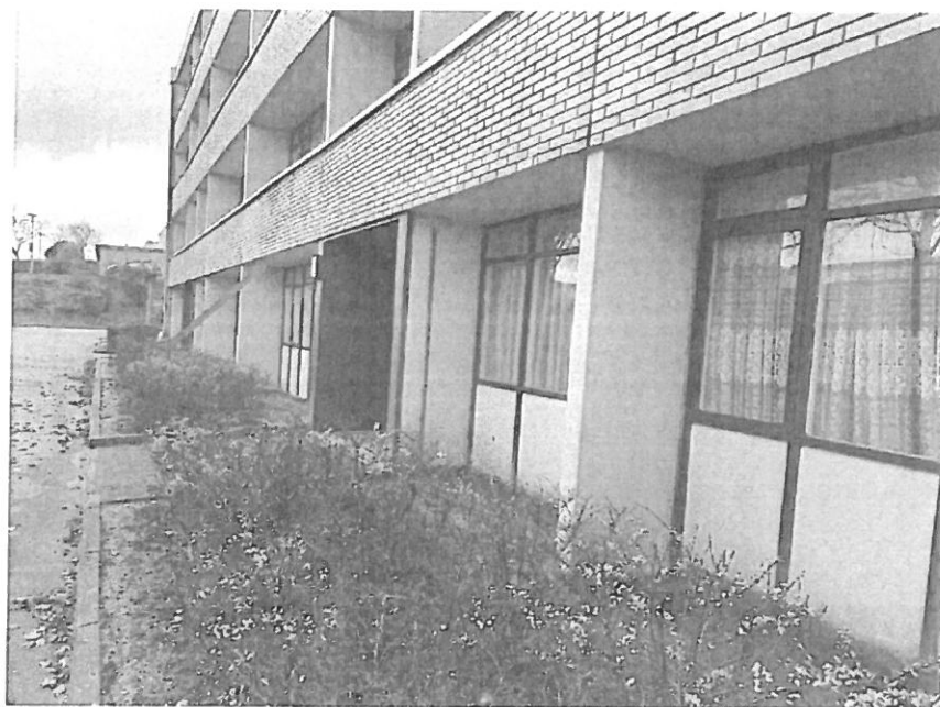
Foto 5: Altanbrystning med tydelig udbøjning.
