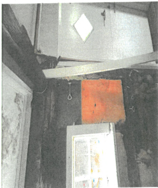
Fugtskade i værelse
