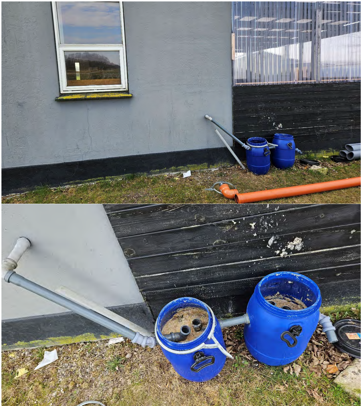
Afløb fra køkkenet til hjemmelavet 2- kamre bundfældningstank. Der er fortsat slam i tankene
