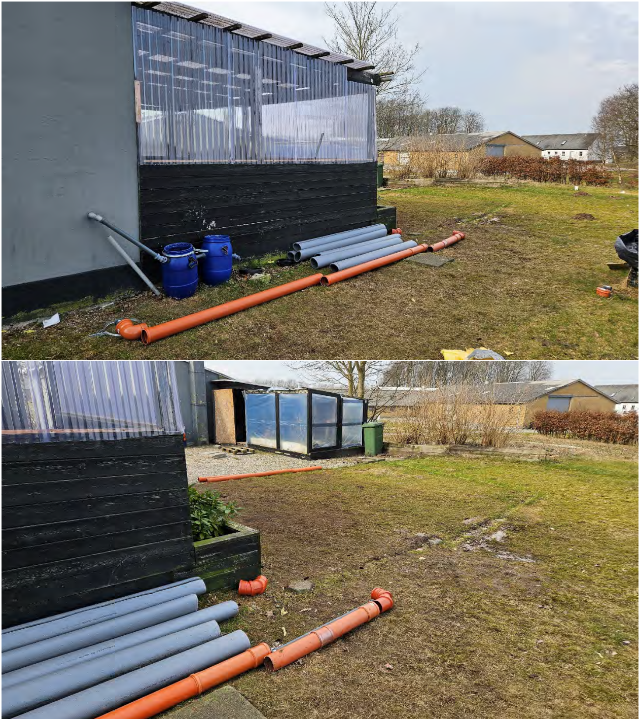
Afløbet blev ledt over til en samlebrønd ved siden af skur/drivhuset. Rørene ved taget op på tilsynstidspunktet, men på billederne fra ejendomscentrets tidligere tilsyn ses de intakte. Forløbet ses fortsat på plæne.
