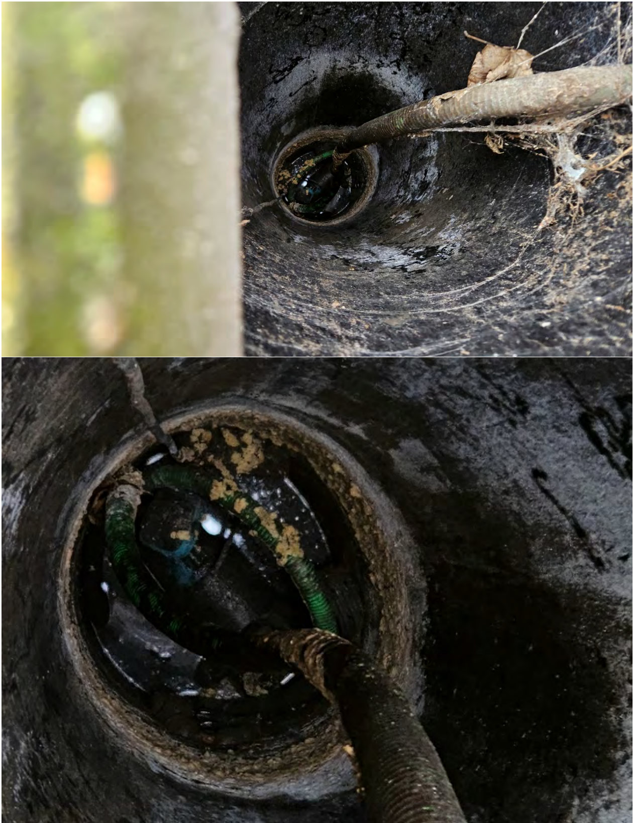
Samlebrønden indvendig. Ved at zoome ind på billedet ses en dykpumpe i bunden. Dykpumpen er tilkøbet en grøn slange, som bliver ledt ud gennem siden af samlebrønden og kommer op ovre i bedet.
