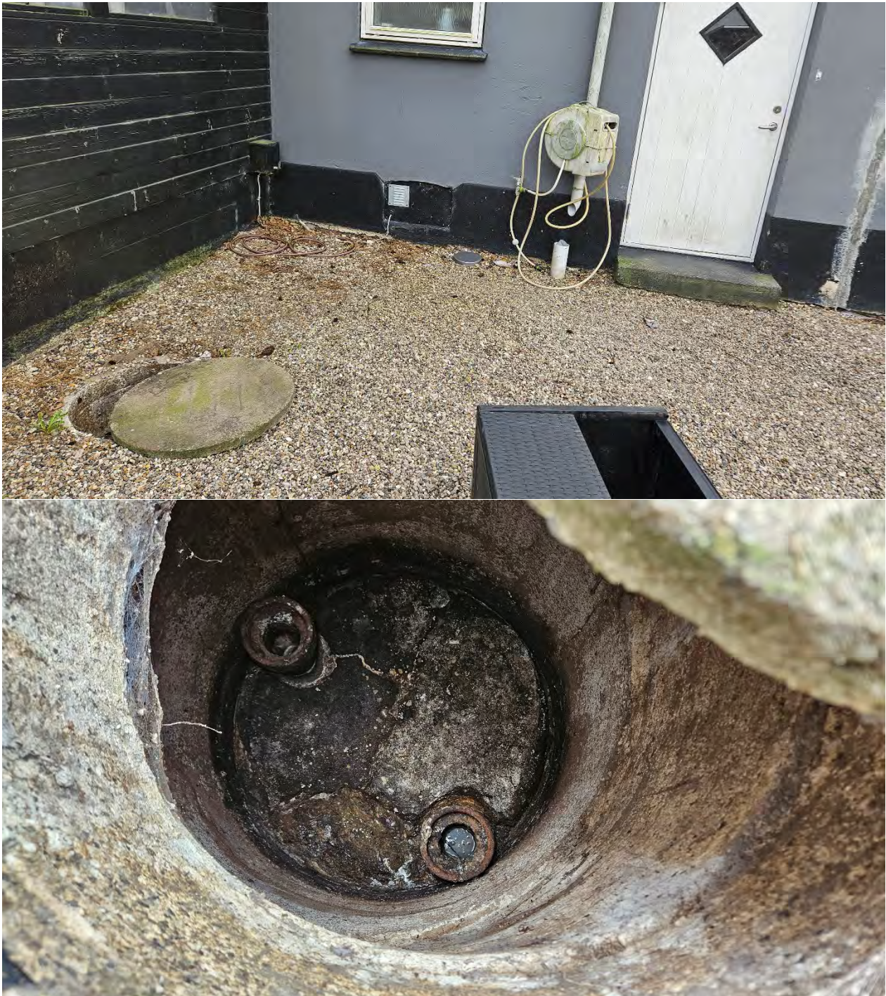
Septiktank inde i gården. T-stykkerne er intakte og der er tykt flydelag.
