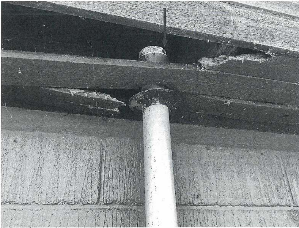
Foto 3: Åbentstående tagnedløb (rød pil).
