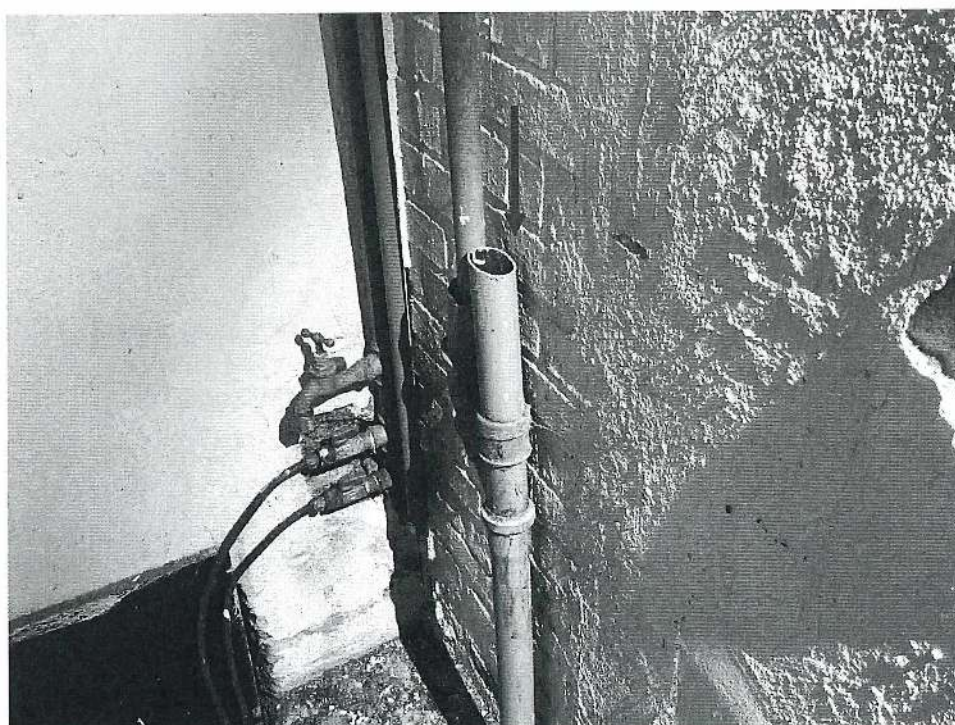
Foto 2: Ikke-afproppet afløbsrør (rød pil)
