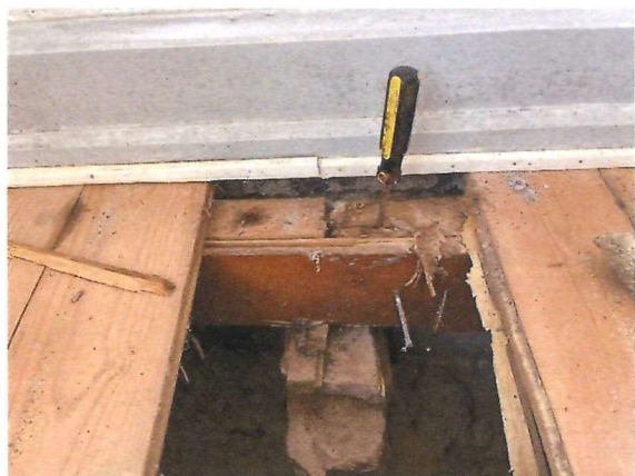
Råd i bjælke i krybekælder
