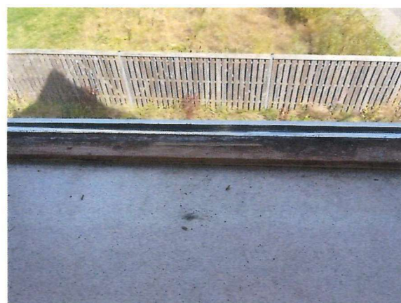
Udbredt skimmel på trævinduet i trapperummet
