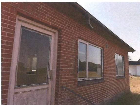
Huset er i dårlig vedligeholdelsesstand - med fugtskader under manglende tagedløb
