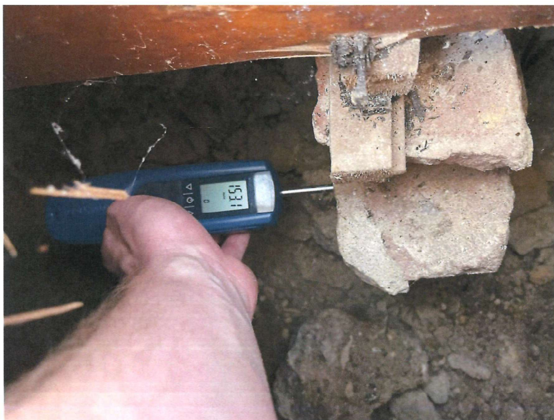
Kraftig forhøjet fugtværdi i mursten (opklodsning) i krybekælder
