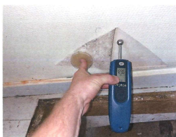
Kraftig opfugtning og skimmelprøve nr. 4 i baggangen
