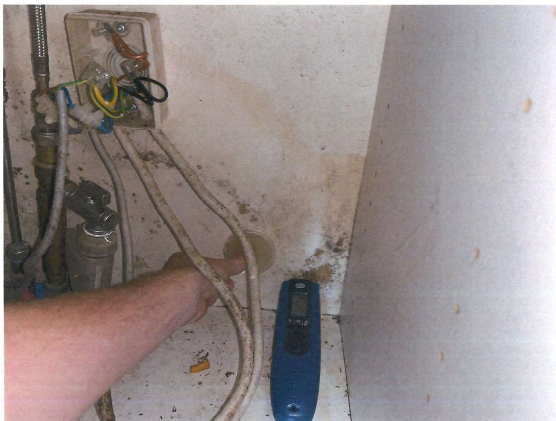
Moderat opfugtning, og skimmelp prøve nr. 1 udtaget i køkkenskab
