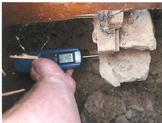
Kraftig forhøjet fugtværdi i mursten (opklodsning) i krybekælder
