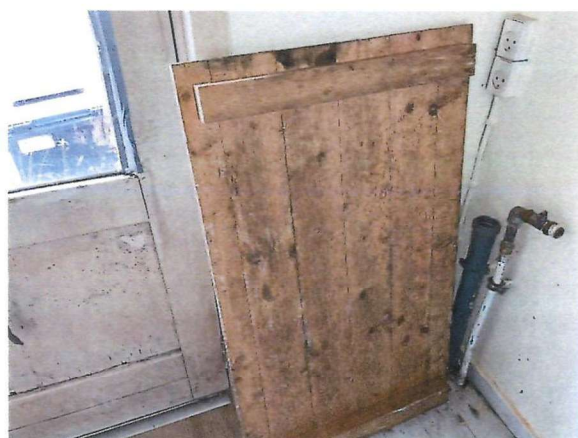
Massiv skimmelvækst på undersiden af gulvlem, og på facadedøren i baggangen
