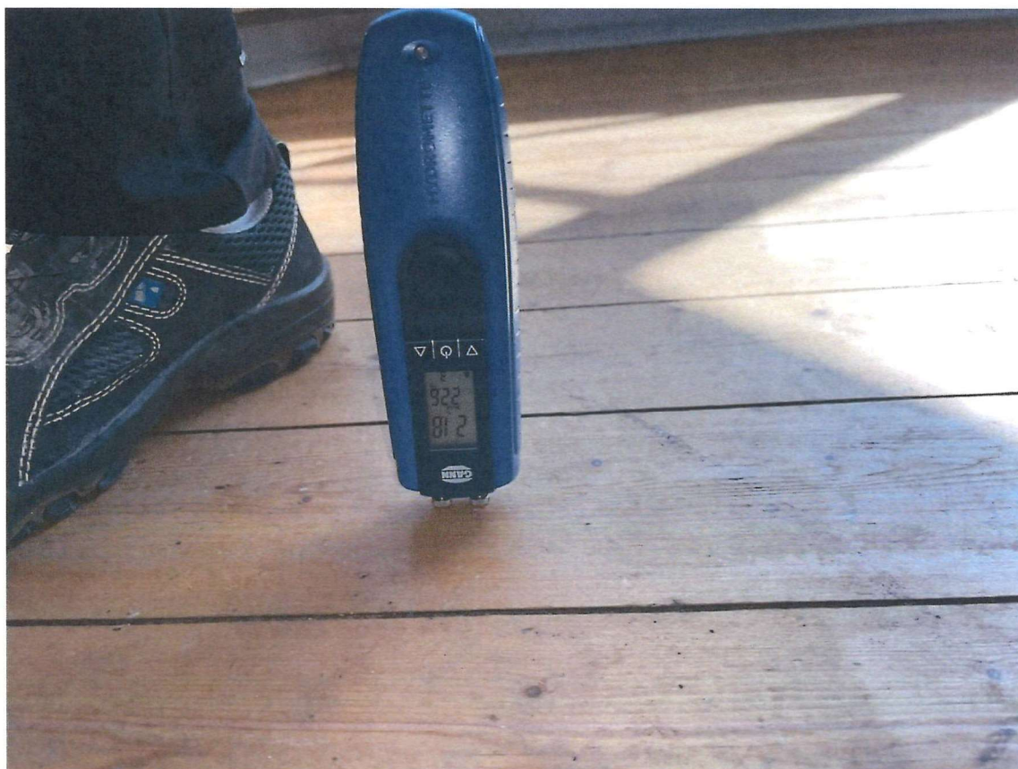
Kraftig opfugtning i de gamle gulvbrædder i stueplan
