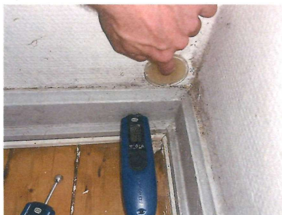
Kraftig opfugtning i gulvpanel og skimmelprøve nr. 2 udtaget i spisesstuen
