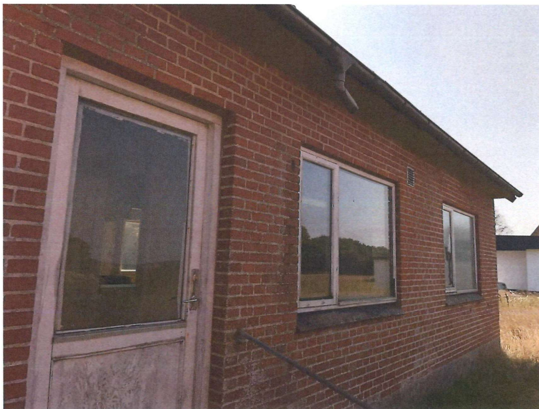
Huset er i dårlig vedligeholdelsesstand - med fugtskader under manglende tagednløb
