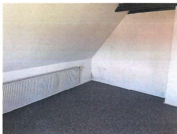
Skimmel i væghjørner ved skunklem i trapperummet
