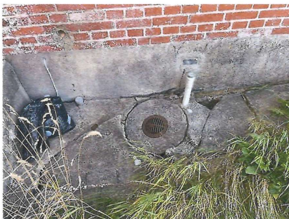
Betonomstøbt kloak er sunket sammen.
