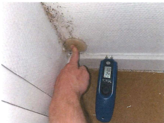
Lettere til moderat opfugtning - og prøve nr. 3 udtaget i trapperummet.
