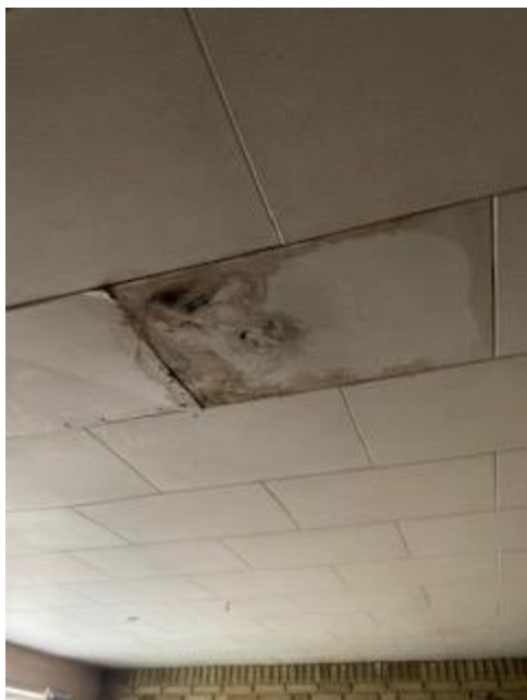
Skade på loft i stue
