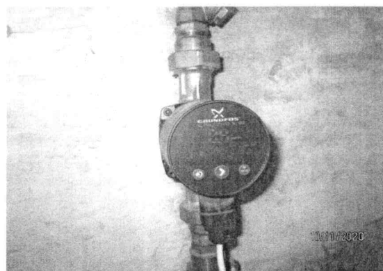
Teknikrum, kælder (cirkulationspumpe, brugsvand).
