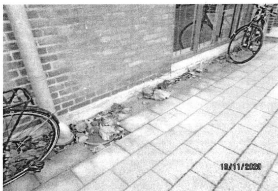
Sokkel, løst puds mod Henriettevej.
