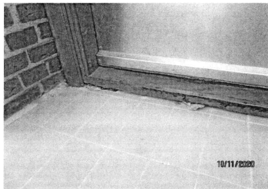
Skade i bundstykke.
