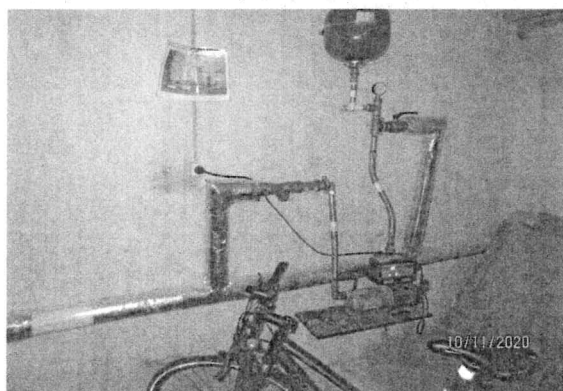
Teknikrum, kælders (trykpumpe).
