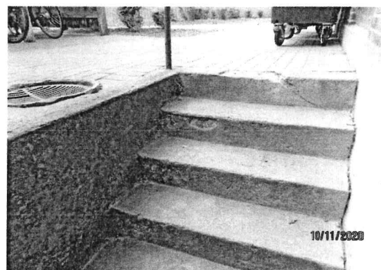
Kældertrappe, afskalning/revner i pudslag og beton.
