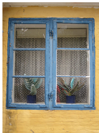
Enkelte vinduer er hængslet på lodposten, bemærk de gamle håndsmedede hjørnebånd.
