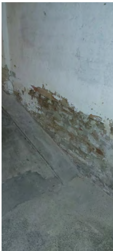
Opstigende grundfugt i kældervægge
