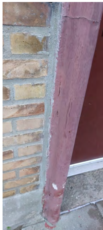
Mørtelfuger fremstår nyligt udskiftede
