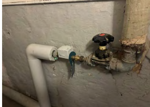
Vandstik, som er udskiftet fra leverandør, samt eksisterende koldtvarsledning.
