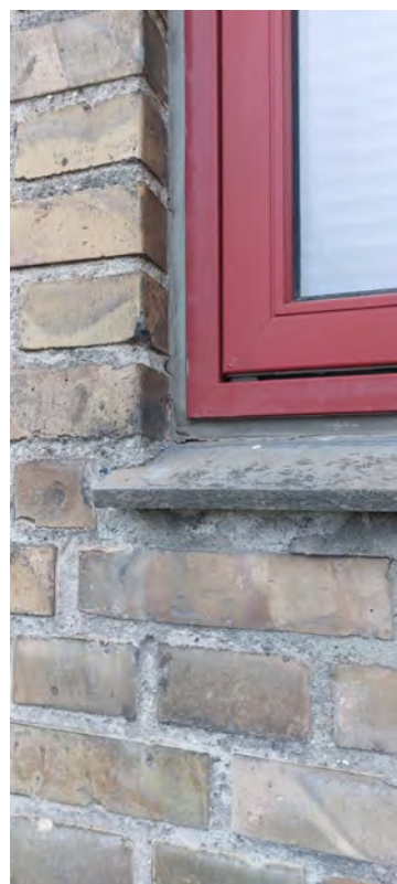
Nedbrydning i fuge om vinduer
