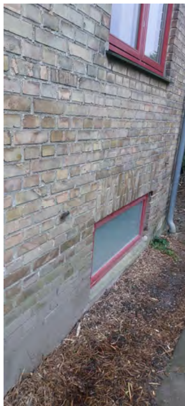
Porøse mørtelfuger mod gård
