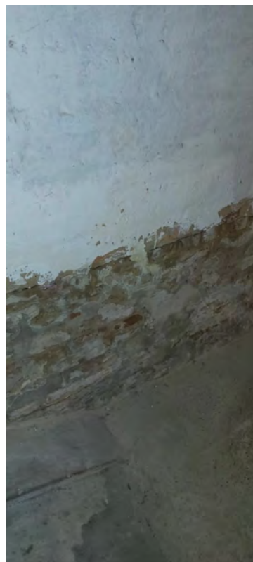
Opstigende grundfugt i kældervægge
