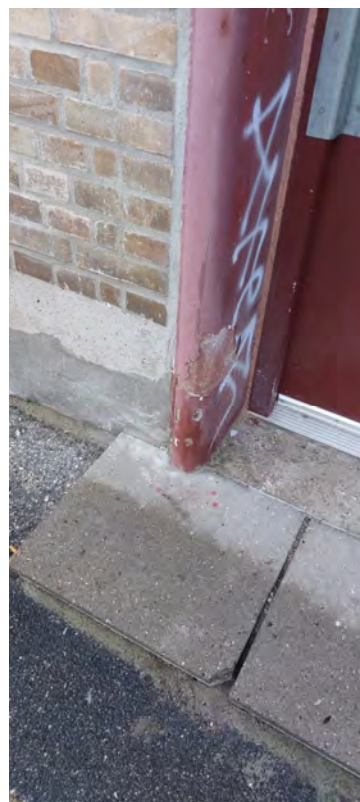
Nedbrydning i overflade samt graffiti ved døre
