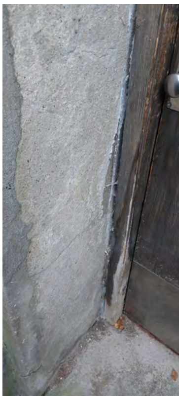
Defekt blød fuge om kælderdør, risiko for PCB-holdig
