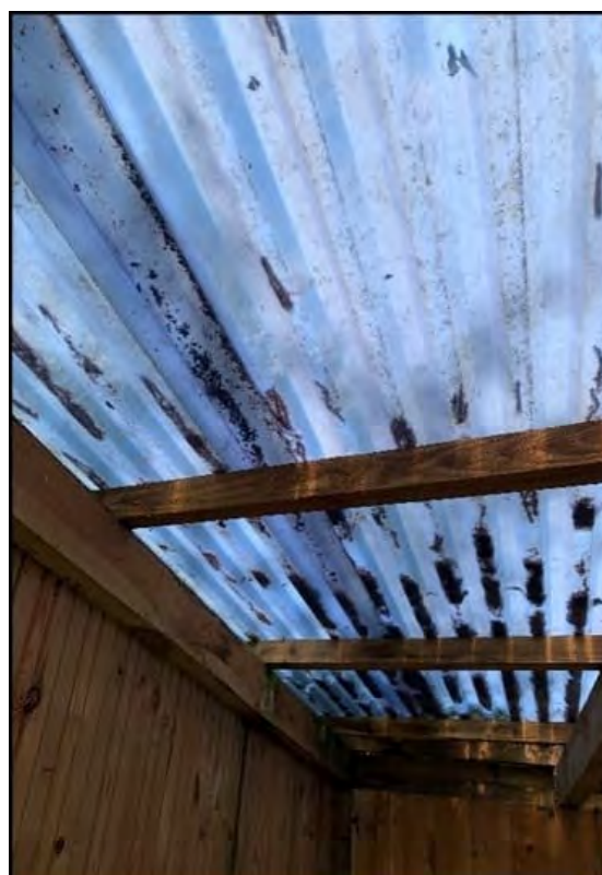
Trapezpladetag i skraldeskur (2021). Tag er siden blevet fjernet
