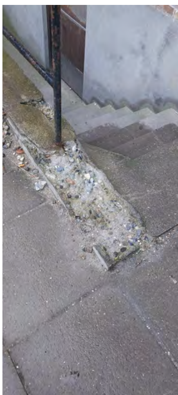
Afskallende beton ved kælderhals i gård
