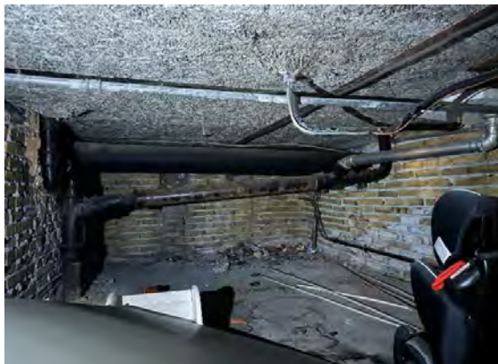
Oprindelig faldstamme i støbejern i krybekælder.
