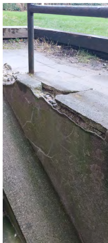
Afskallende beton ved kælderhals i gård
