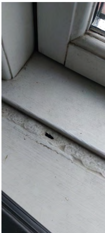
Nedbrydning i fuge ved vindue
