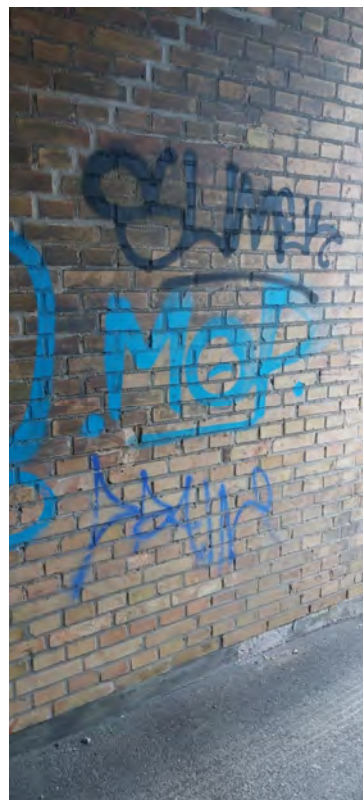
Porøse mørtelfuger i passage ved port
