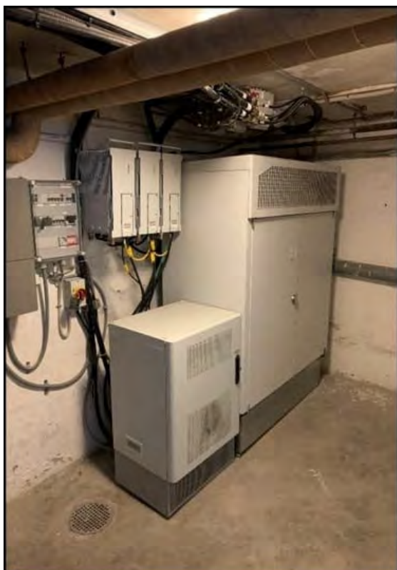
El-forsyning m.m. i kælder til mobilmast
