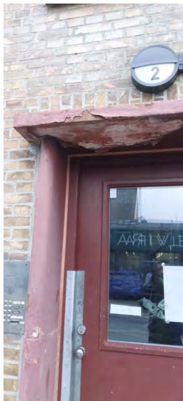
Nedbrydning i overflade ved døre
