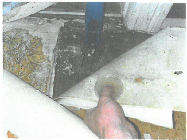
Kraftig opfugtning og skimmelprøve nr. 4 udtaget i køkken
