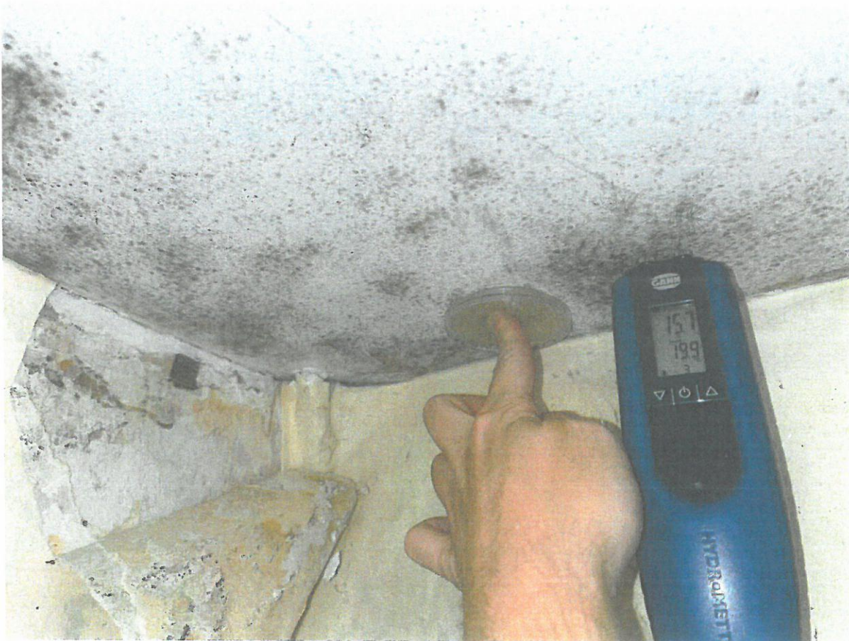
Moderat opfugtning og skimmelpølse nr. 5 udtaget på loft i entre
