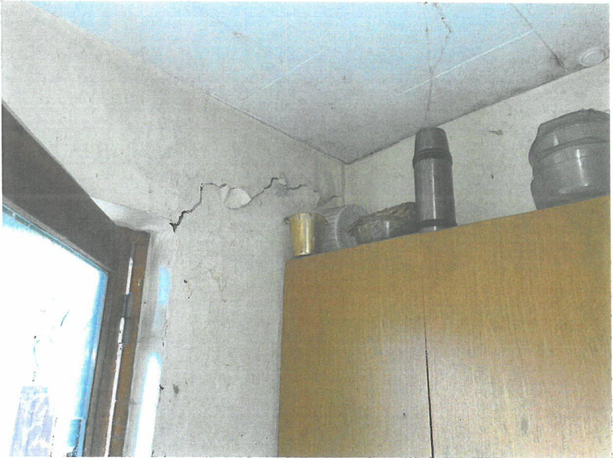
Betydelig revne i murværket
