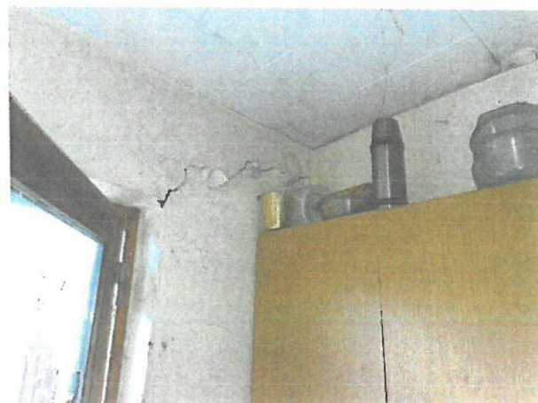
Betydelig revne i murværket
