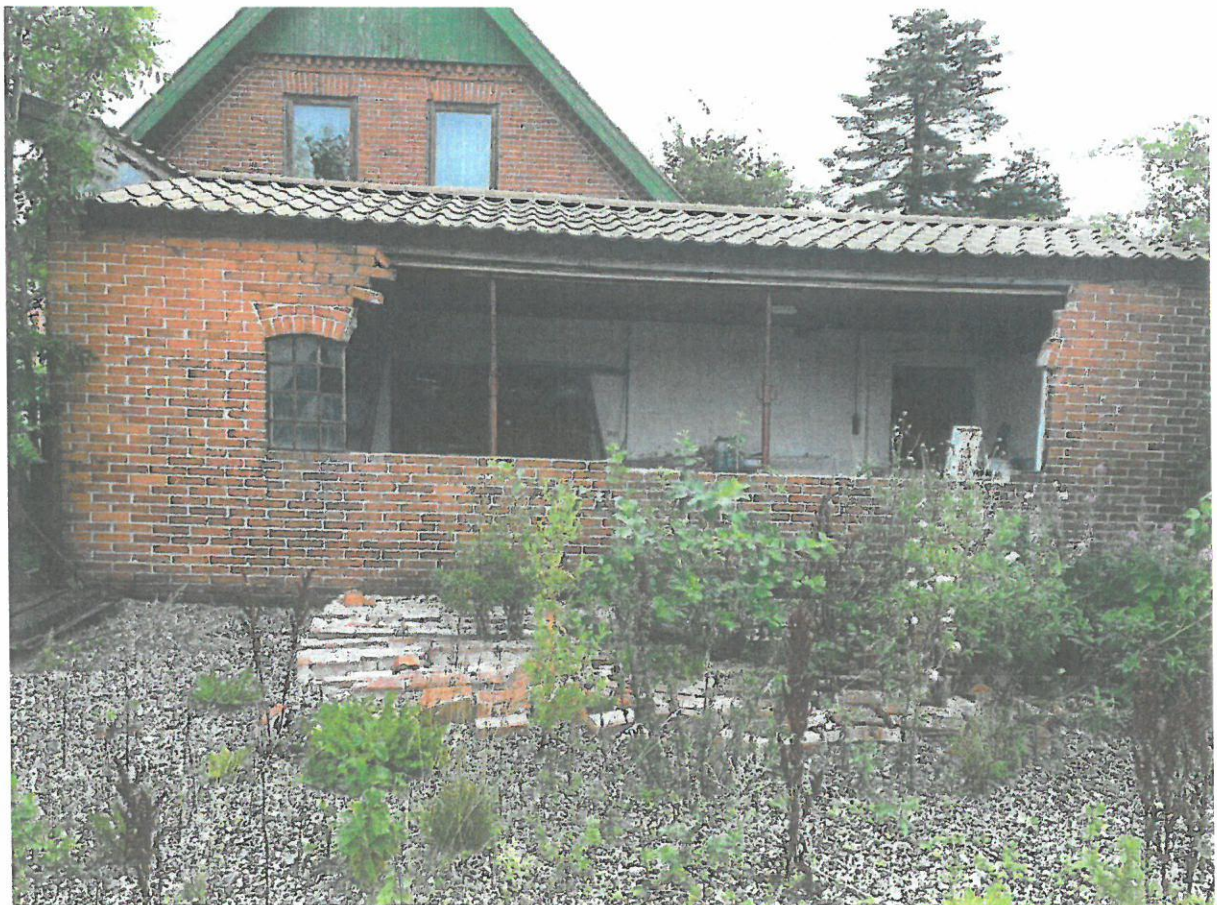
Sammenstyrftet murværk i udbygning ligger på nabogrunden
