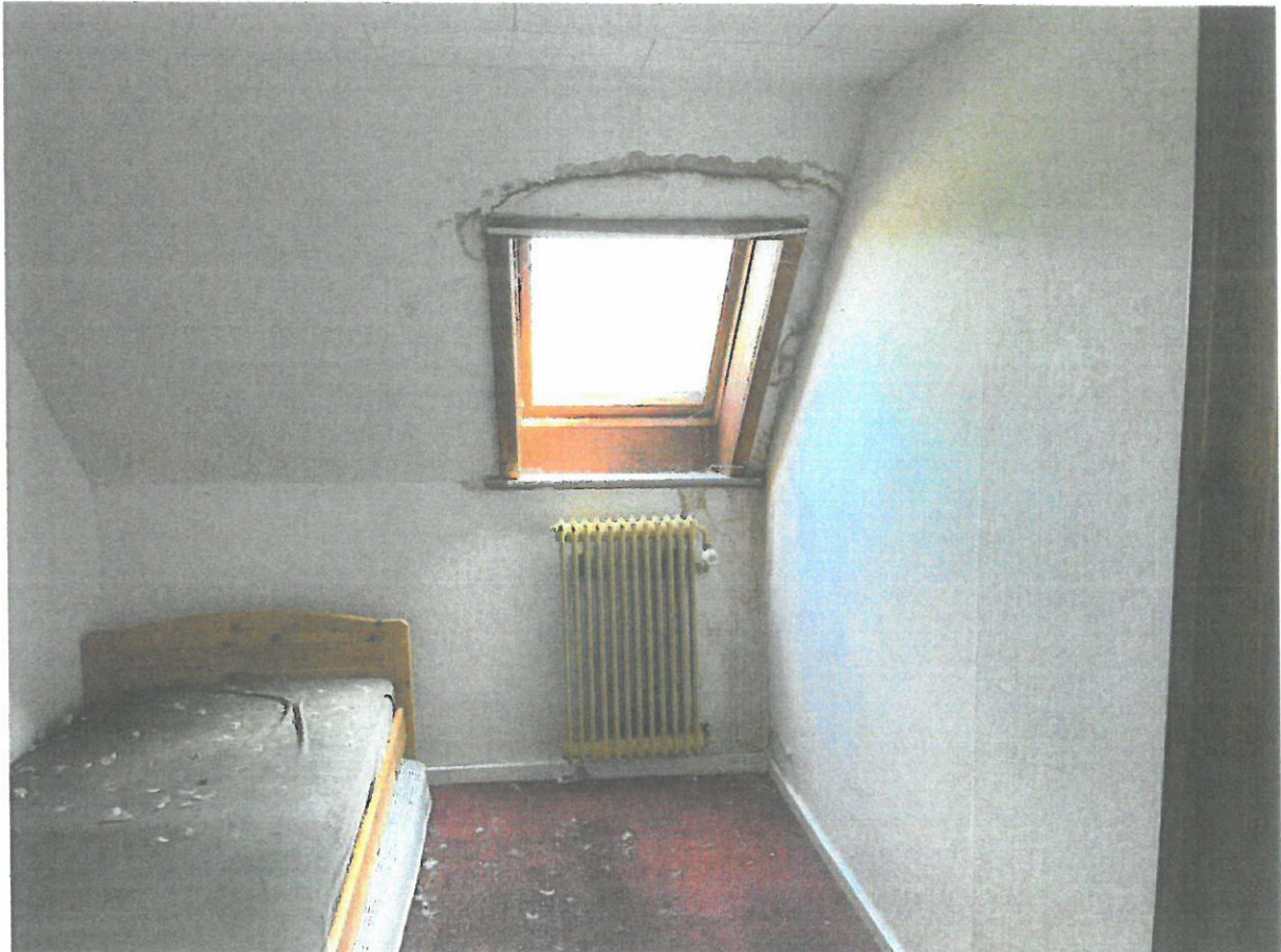
Vandindtrængning ved tagvindue
