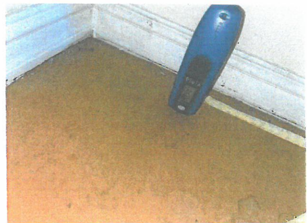
Kraftig opfugtning i gulvspån i stuen, område for skimmelprøve nr. 3
