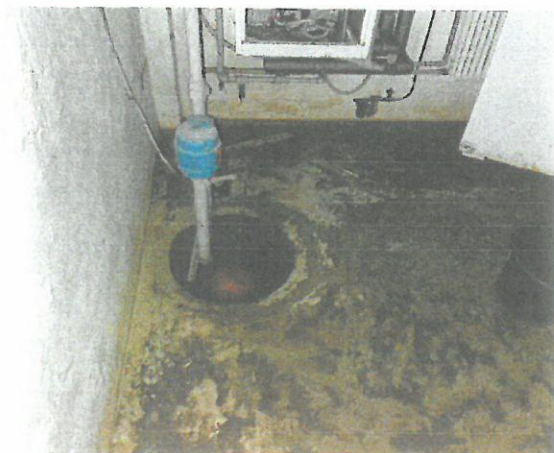
Der ligger blankt vand på gulvet i kælderen under køkkenet
