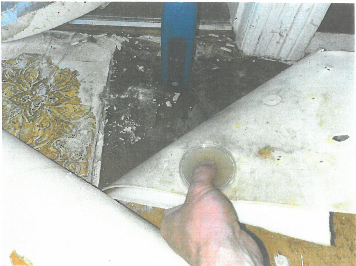
Kraftig opfugtning og skimmelp prøve nr. 4 udtaget i køkken
