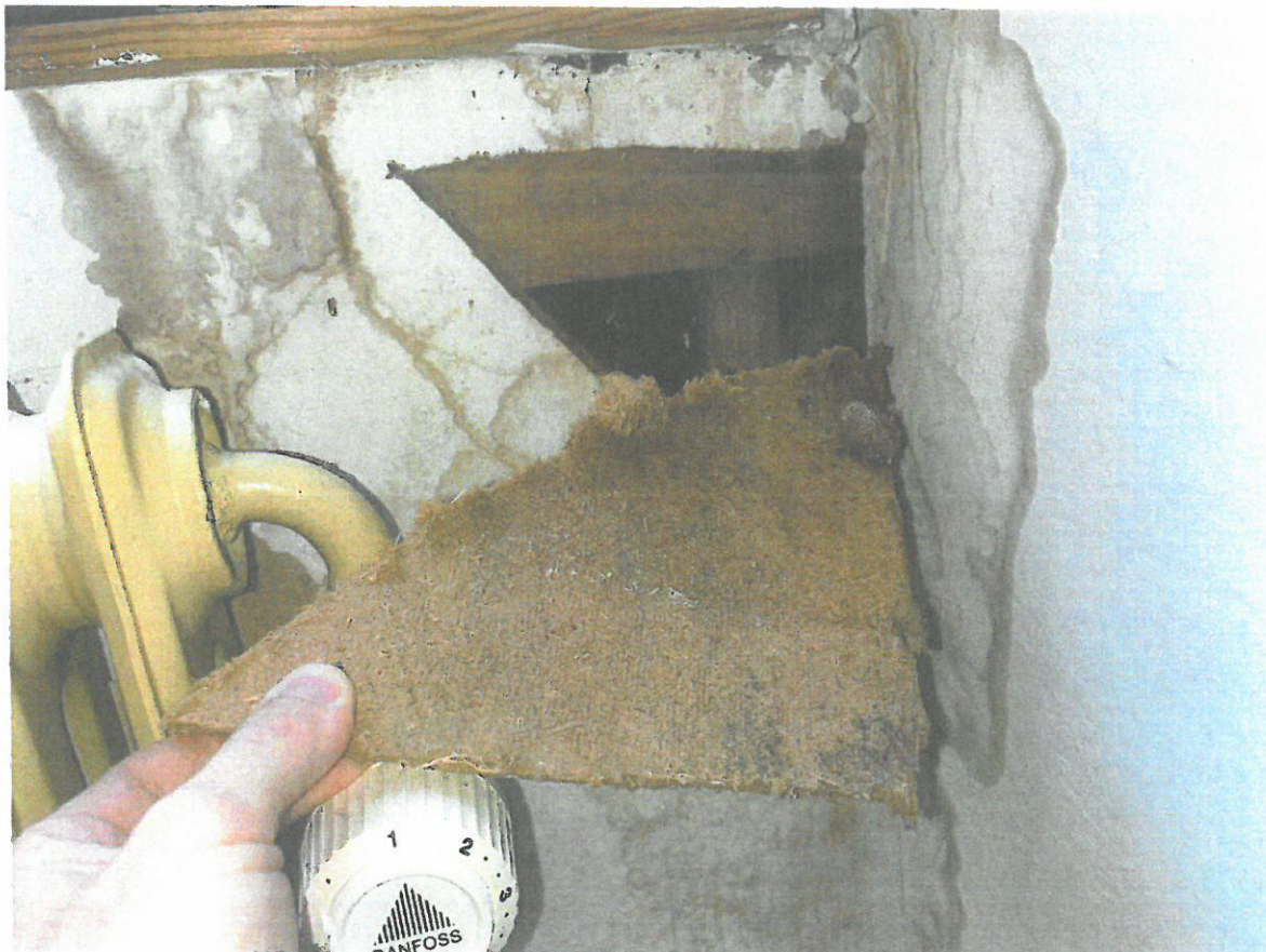
Brandfarlige træfiberplader og misfarvninger af skimmel område for skimmelprøve nr. 2
