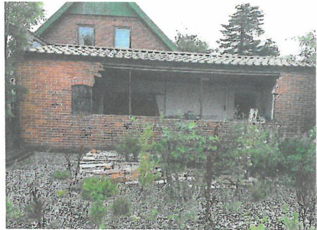
Sammenstyrtet murværk i udbygning ligger på nabogrunden
