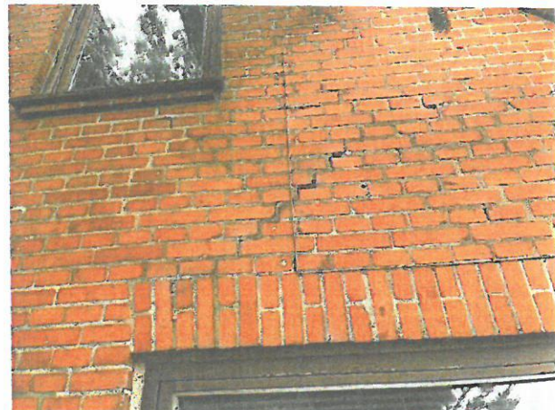
Betydelige revner i murværket der er gennemgående
