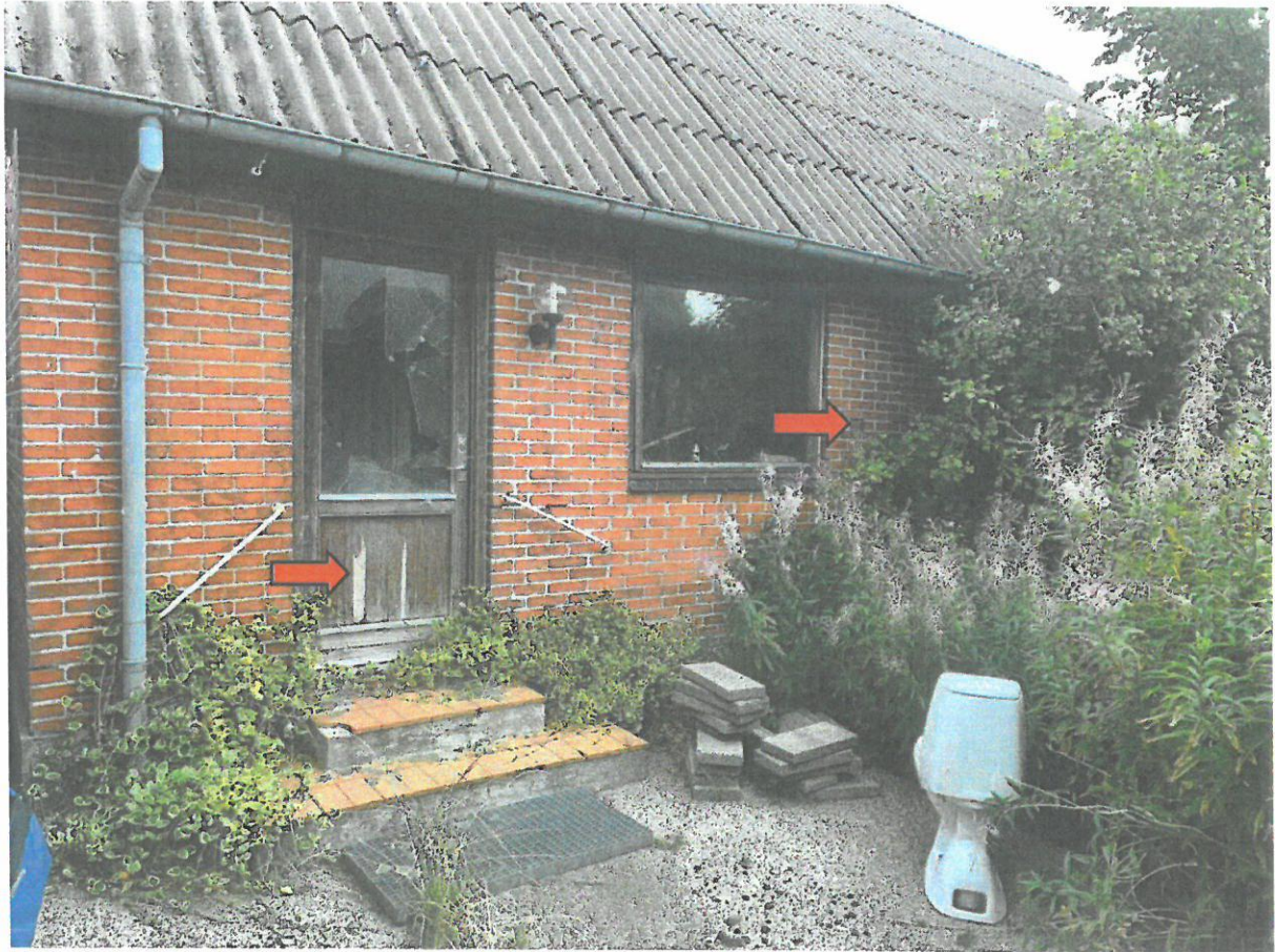
Rådskadet facadedør partielt manglende mørtelfuger og bevoksning vokset vildt
