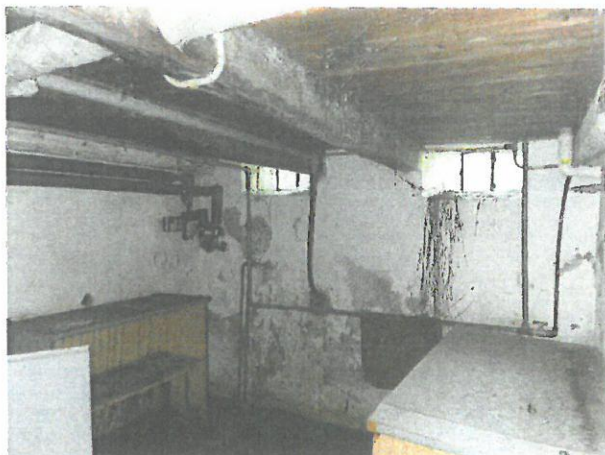
Fugtskadede kældervægge under køkkenet
