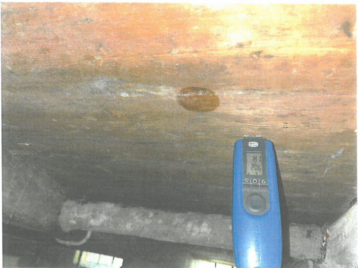
Massiv skimmelvækst på loftbrædder i kælderen- kraftig opfugtning og område for skimmelprøve nr. 1
