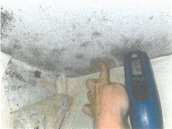
Moderat opfugtning og skimmelprøve nr. 5 udtaget på loft i entre
