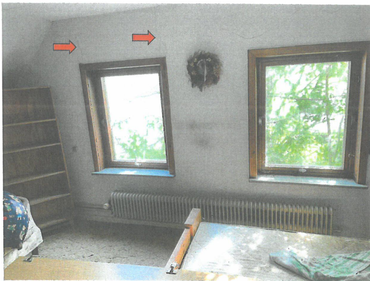
Gennemgående revne i murværk over gavlvinduet
