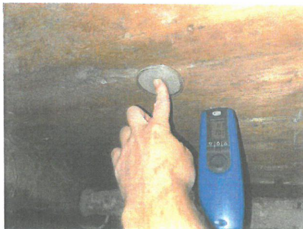
Massiv skimmelvækst på loftbrædder i kælderen - kraftig opfugtning og område for skimmelprøve nr. 1
