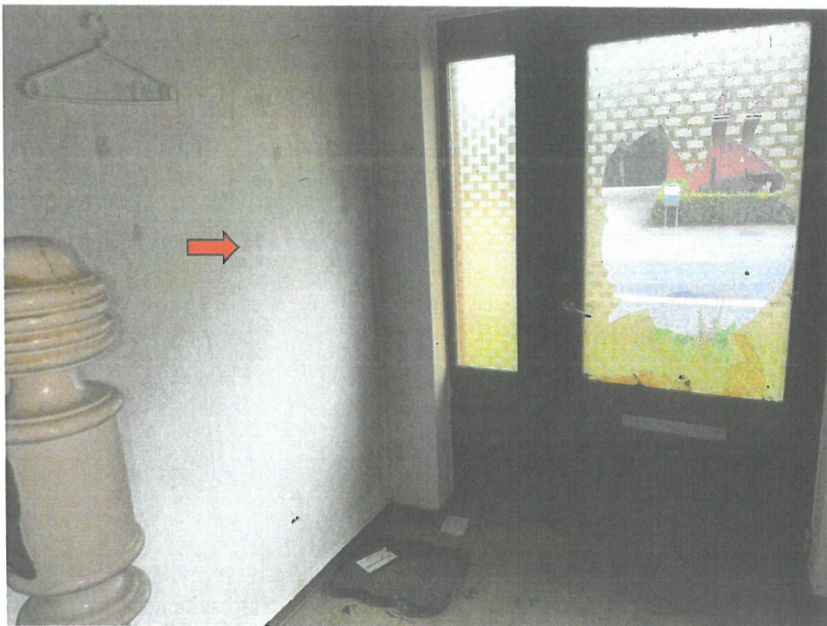
Udbredt skimmelvækst på væg i trapperummet
