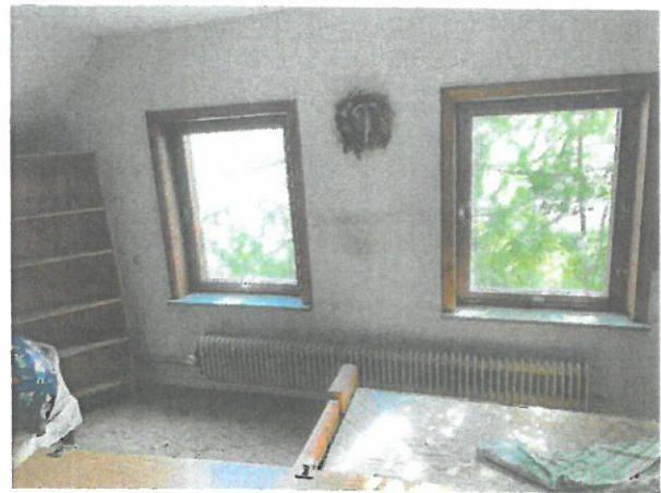
Gennemgående revne i murværk over gavlvinduet
