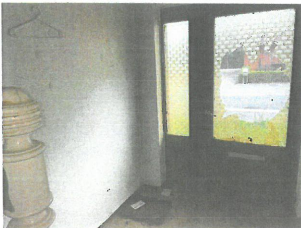
Udbredt skimmelvækst på væg i trapperummet
