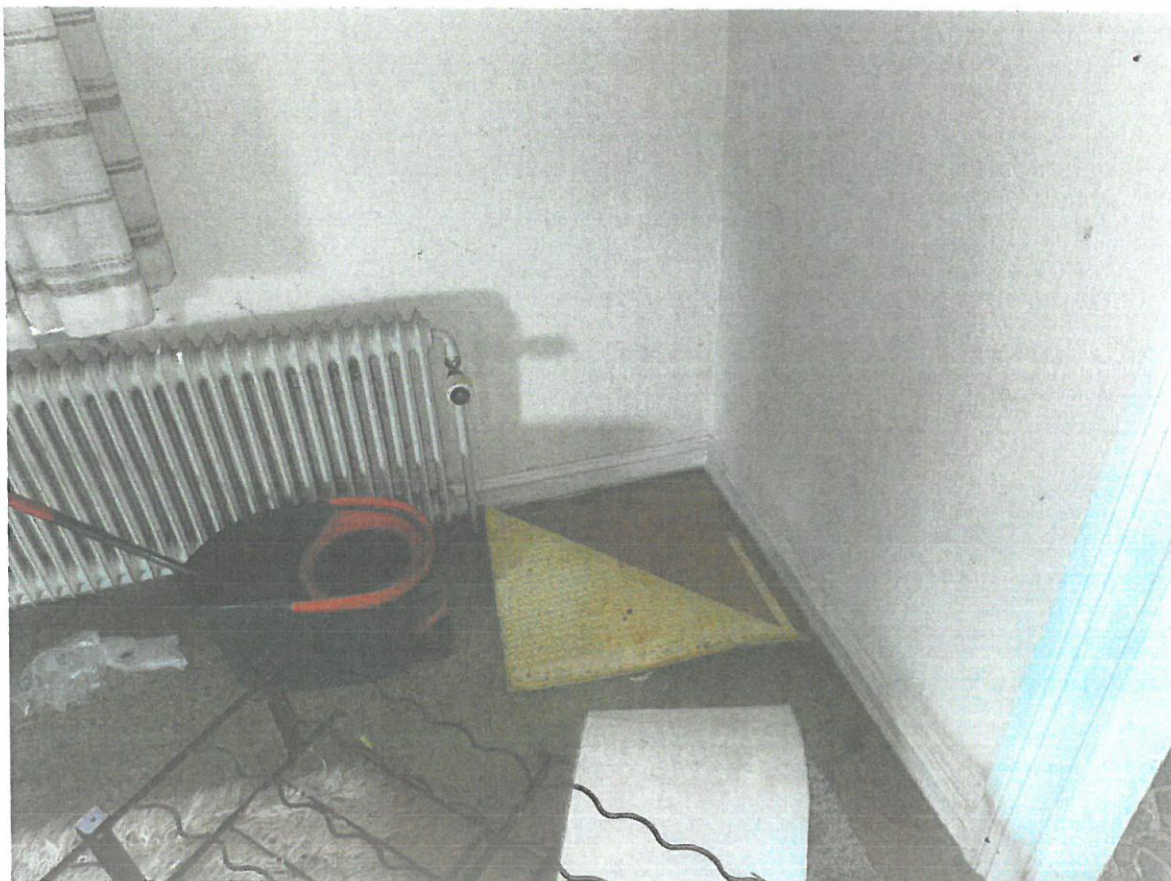
Misfarvninger på bagside af tæppe i stuen, område for skimmelprøve nr. 3
