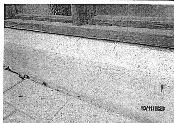
Sokkel, revnedannelse i puds mod Annasholmsgade.
