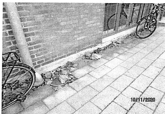
Sokkel, løst puds mod Henriettevej.
