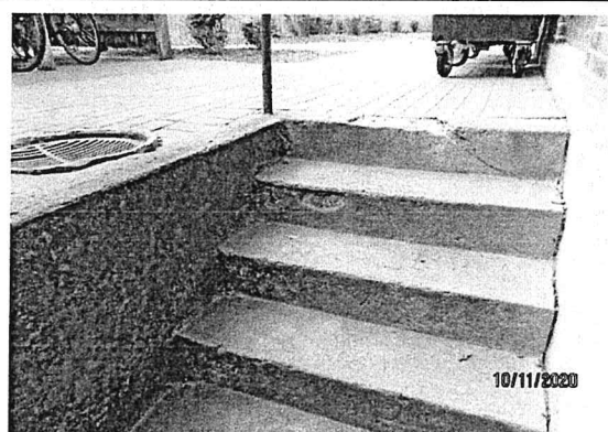
Kældertrappe, afskalning/revner i pudslag og beton.
