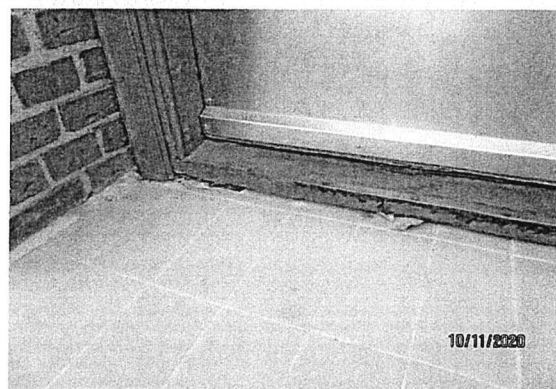
Skade i bundstykke.
