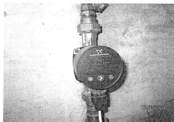
Teknikrum, kælder (cirkulationspumpe, brugsvand).
