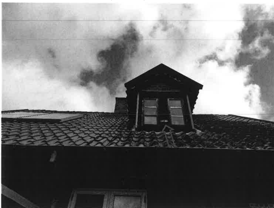
Foto 4 Udvendige forhold Der ses lokal skade på beklædning af kvist (rød pil). Skaden medfører risiko for vandindtrængning i ydervægskonstruktionen og den underliggende tagkonstruktion.
