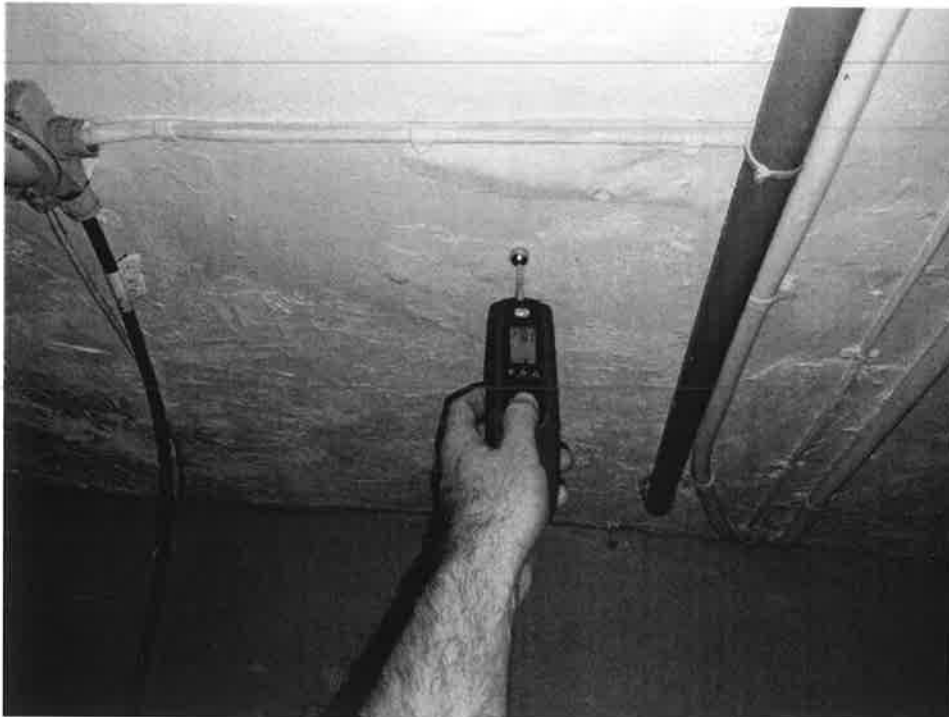
Foto 14 Kælder – fyrrum Der ses skader på puds og maling på yder- og skillevægge. Der måles vådt (>130 digits) i varierende omfang på væggene.
