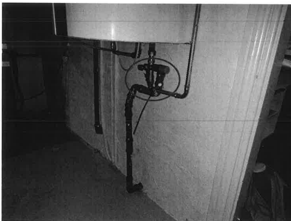
Foto 16 Kælder – utætte installationer Der konstateres konstant udsivning af vand fra sikkerhedsventil (rød cirkel) som følge af fejl i ventilen.
