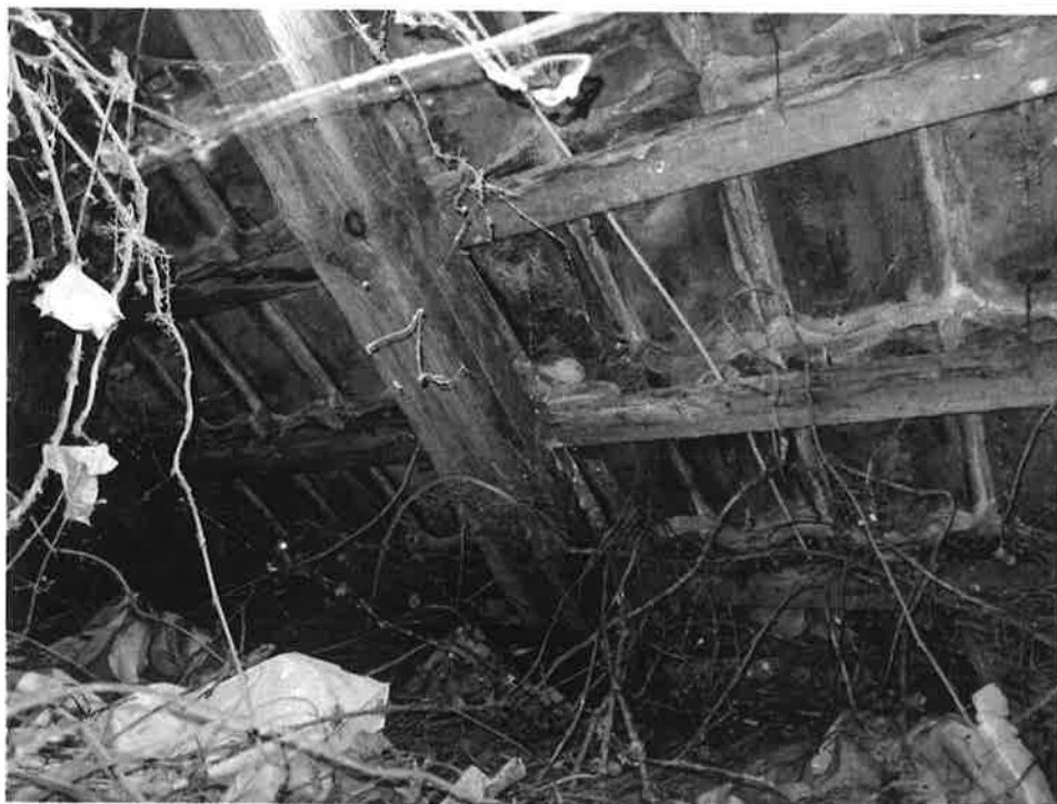
Foto 37 Tagkonstruktion (skunkrum mod nord) Der ses plantevækst i tagkonstruktionen i skunkrummet. Undersiden af tagstenene er misfarvede.
