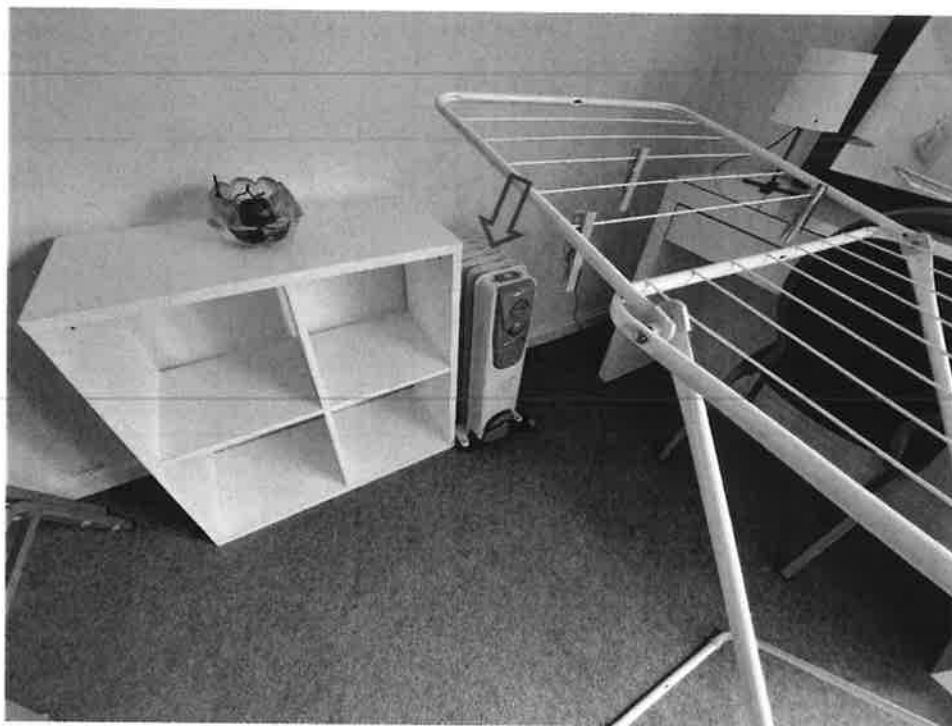
Foto 32 Værelse 2 Decentral el-radiator (rød pil) er opsat på grund af manglende drift på centralvarmesystemet.
