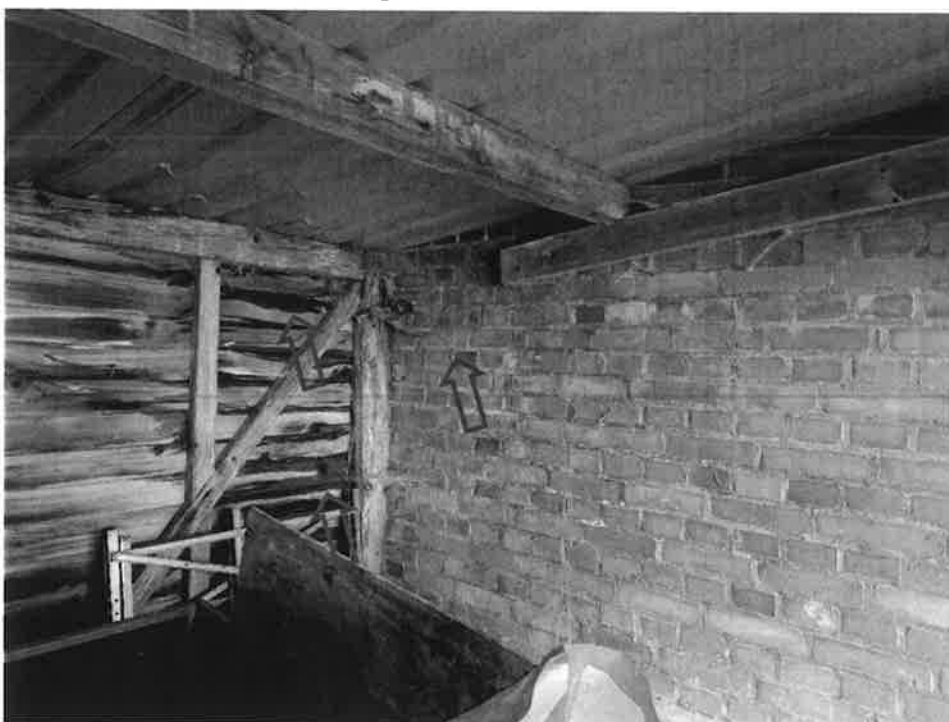
Foto 8 Udvendige forhold Der ses fugtskjolder på murværk og træbeklædt gavl i garage (røde pile). Fugtskjolderne er forårsaget af utilsigtet opfugtning og utilstrækkelig afvanding fra de to tage.
