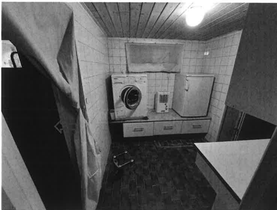
Foto 11 Kælder – bryggers Bemærk, at der ikke er dør mod tilstødende kælderrum (rød pil). Beboer oplyser, at der nogle gange trænger vand ind på gulv i bryggers som følge af vand på gulv i tilstødende disponibelt kælderrum.
