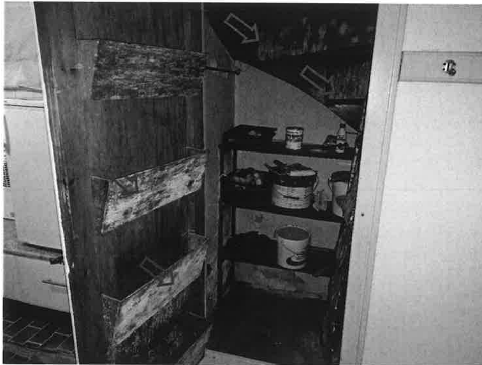
Foto 13 Kælder – fyrrum I skab under trappe ses kraftig skimmelsvampevækst på indvendige overflader i skabet, bl.a. på underside af trappeløbet (røde pile). Der er tydelig lugt af fugt og skimmelsvamp i skabet.
