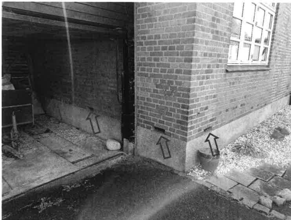
Foto 9 Udvendige forhold Krybekælder er ventileret via traditionelle metalriste i bunden af ydervæggene (røde pile). Ristene er fri og funktionelle, dog er flere riste placeret hhv. i garage og bag skraldespand, hvilket reducerer deres effekt i forhold til hvis de var fri.
