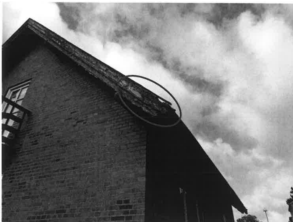
Foto 3 Udvendige forhold Der ses stedvist skader på boligens vindskeider. Her ses afskallende maling og rådkader som følge af mangelfuldt vedligehold (rød cirkel).
