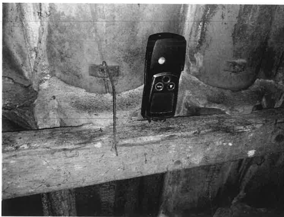
Foto 38 Tagkonstruktion (skunkrum mod nord) Der måles fugtigt (20 % træfugt) i overside af lægter. Prøve MM-1 er udtaget på misfarvede tagsten.
