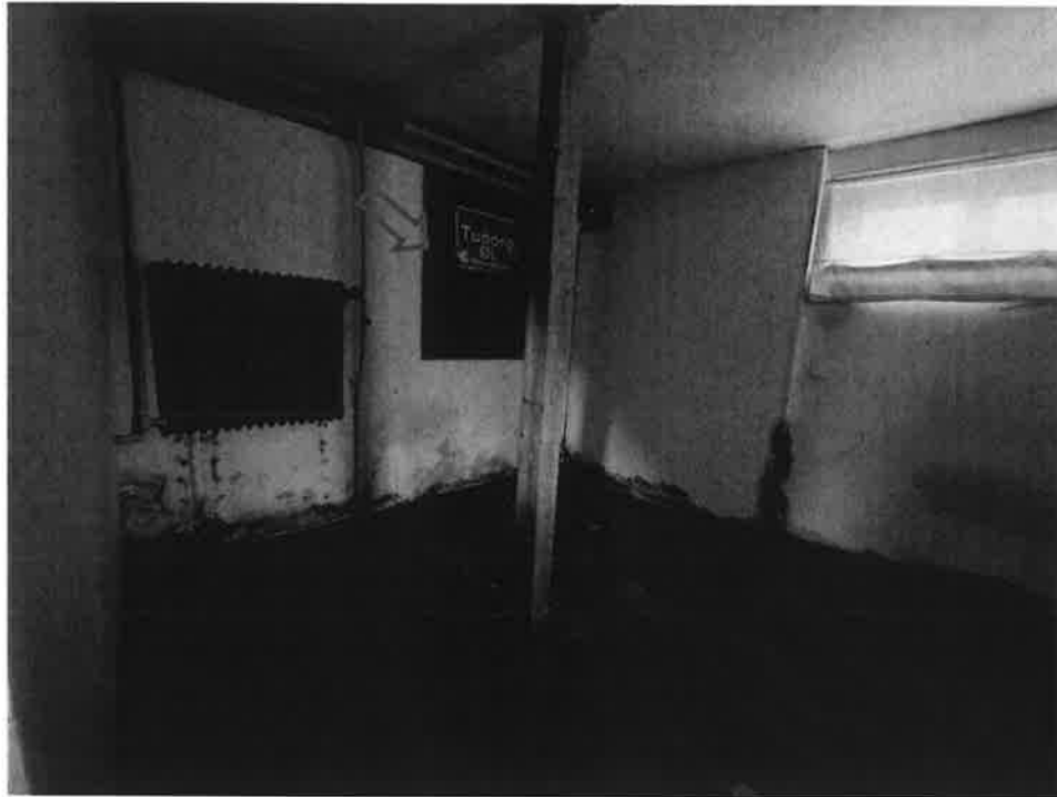
Foto 19 Kælder – disponibelt kælderrum Der ligger blankt vand på gulvet i kælderrummet. Vægge er beklædt med (gips)plader, der har suget fugt op og fremstår med kraftig skimmelsvampevækst. Lem til krybekælder (rød pil).
