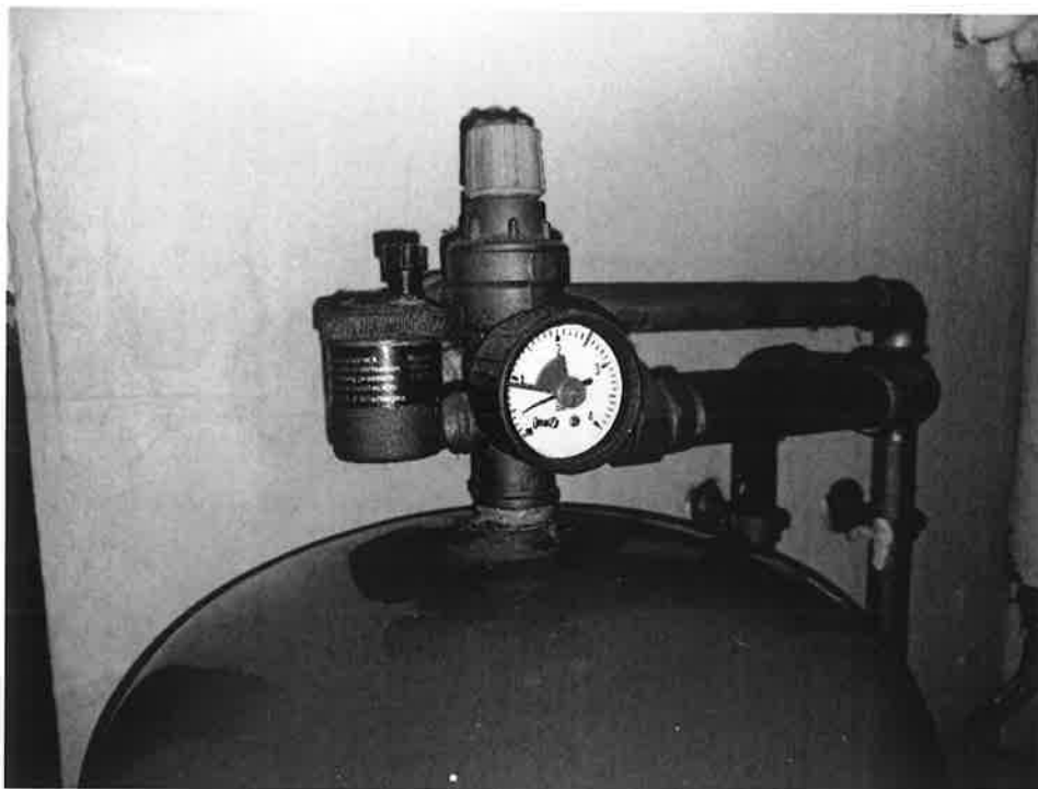
Foto 41 Kælder – Installationer Der konstateres ingen tryk på centralvarmesystemet.
