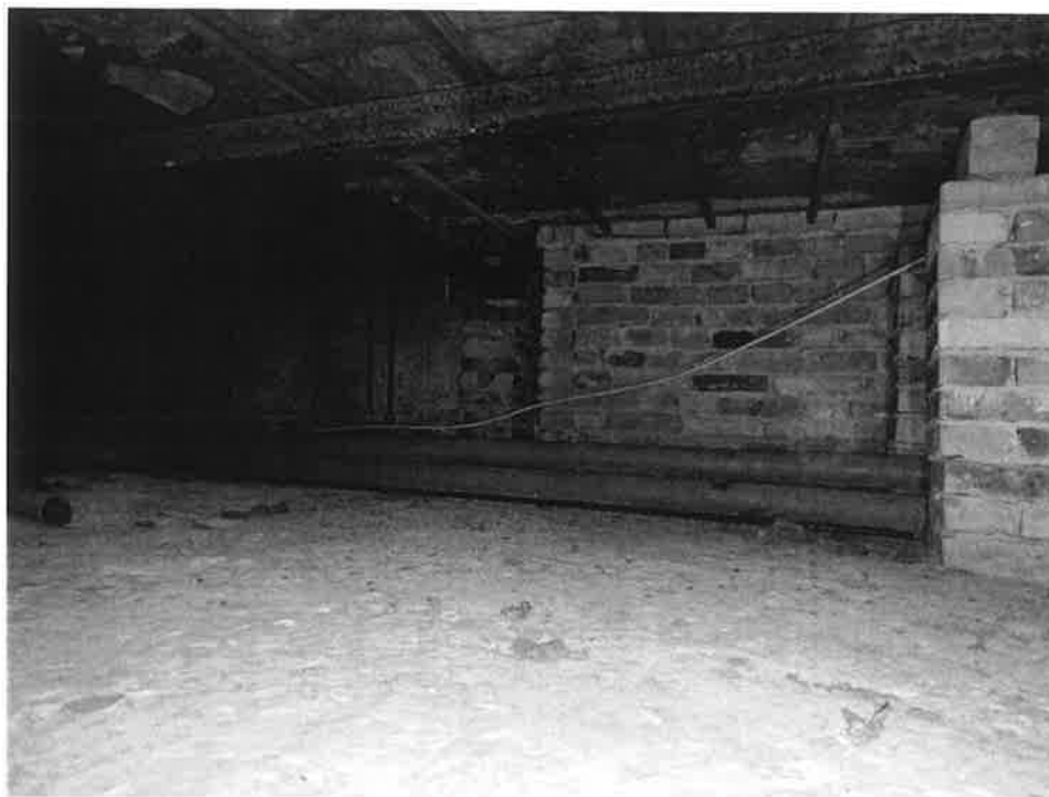
Foto 23 Kælder – krybekælder Bunden af krybekælderen er relativt ryddelig. Der måles fugtigt – vådt (100 - >140 digits) i bunden. Prøve AF-7/MM-3 er udtaget her.
