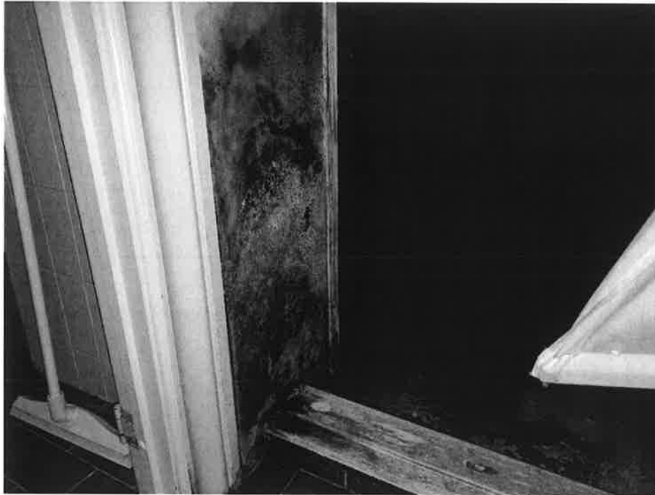
Foto 17 Kælder – disponibelt kælderrum Lysningen mellem bryggers og disponibelt kælderrum er kraftigt angrebet af skimmelsvamp.
