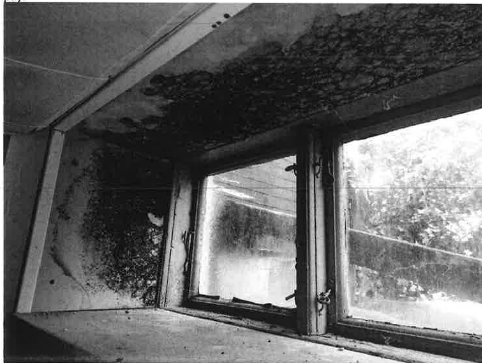
Foto 20 Kælder – disponibelt kælderrum Lysning omkring vinduer er kraftigt angrebet af skimmelsvamp.
