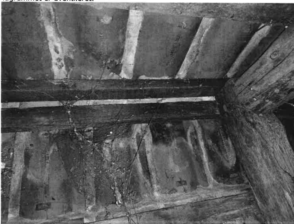
Foto 40 Tagkonstruktion (tagrum) Kippen set nedefra. Rygningen er udført med mørtel, hvorfor der ikke er mulighed for nogen ventilation af tagrummet.
