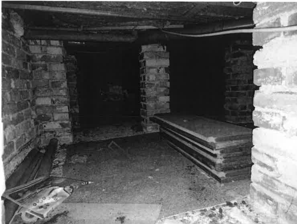
Foto 21 Kælder – krybekælder Der er udlagt gulvtæppe på bunden i krybekælderen (rød pil). Organisk materiale medfører øget risiko for skimmelsvampevækst.
