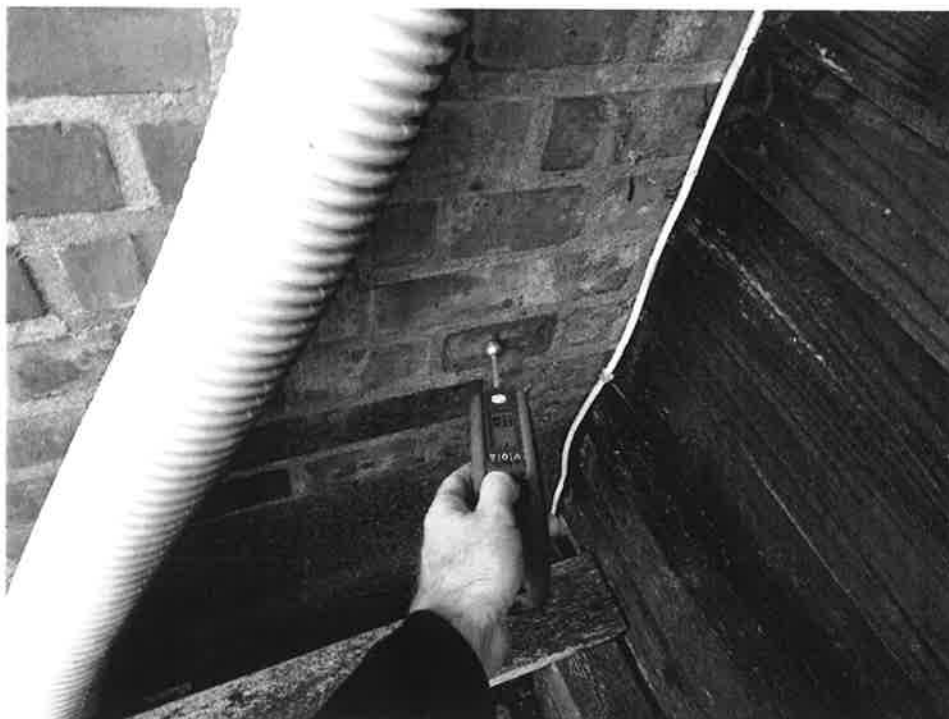
Foto 7 Udvendige forhold Der måles fugtigt (ca. 100 digits) i murværk med algevækst af utilsigtet opfugtning og utilstrækkelig afvanding fra de to tage.
