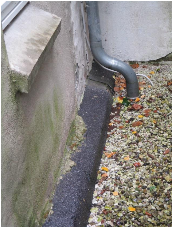
Sokkel for enden af smøgen med efterisoleret sokkel. Gulv i lejlighed ligger under terræn uden sikring af tætning mellem pap og murværk samt misfarvet og skadet vandskuring.
