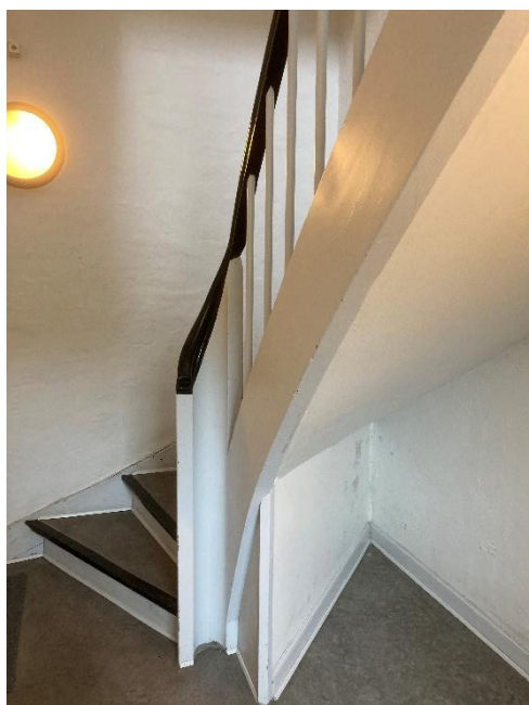
Trappe i opgang til nr. 8C
