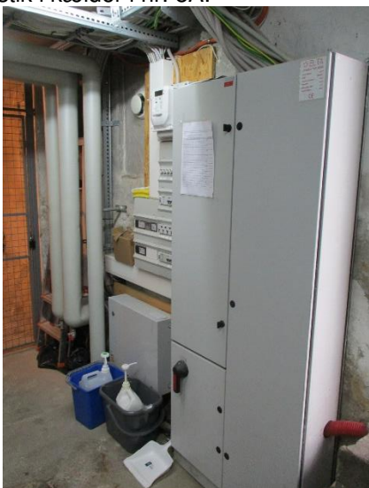
Hovedeltavle i kælder i nr. 8A
