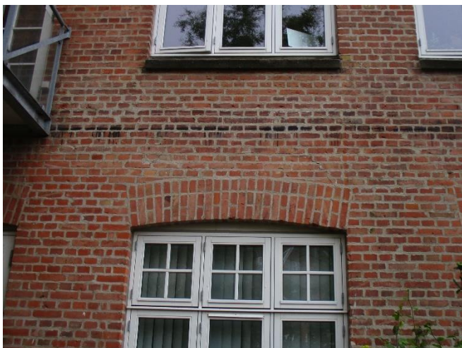
Muret stik med revner i murværk ovenover
