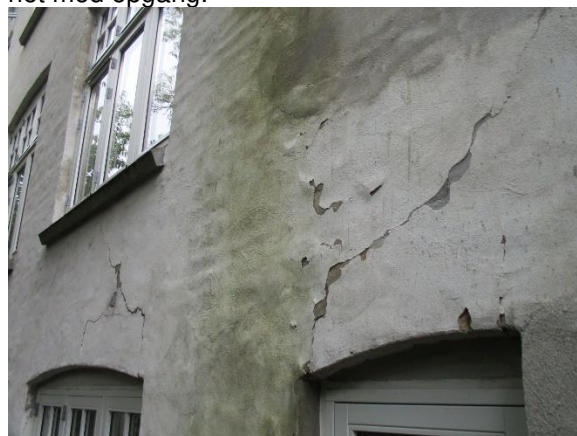
Afskallet og fugtskadet vandskuring på bagfacade af nr. 8C
