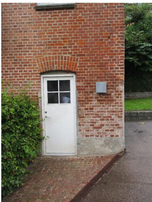
Facade ved dør til opgang til nr. 8C med fugtskader i murværk og sokkelpuds
