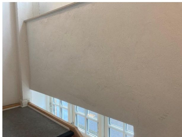
Revne i ydervægsbrystning i trappeopgang i nr. 8B
