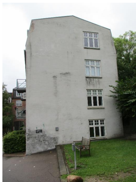
Fugtskadet gavlf med vandskuring af 8C, især på hjørnet mod opgang.
