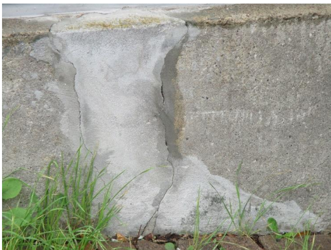
Repareret sokkel med revnedannelser ud mod Mønsgade
