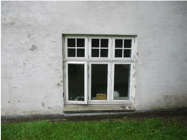
Sokkel på bagfacade af 8C tæt på terræn – vandskuring ses med misfarvning og opfugtning/afskalninger.
