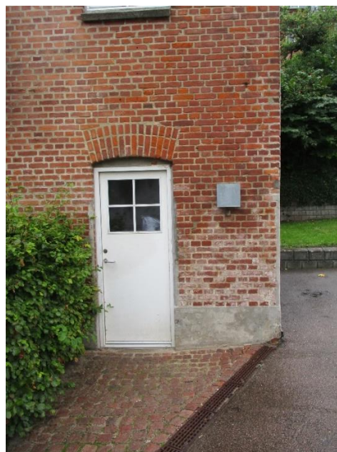
Murværk ved opgang til 8C misfarvet/fugtskadet
