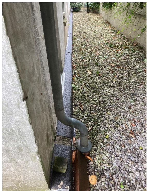
Sokkel på facade af 8C med efterisolering afdækket med pap uden sikring af tætning mod mur. Mangler afdækning bag tagnedløb
