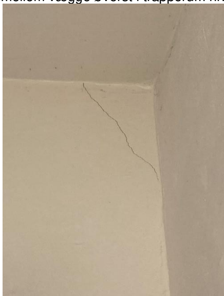
Revne i vægge øverste i trappeopgang til nr. 8B
