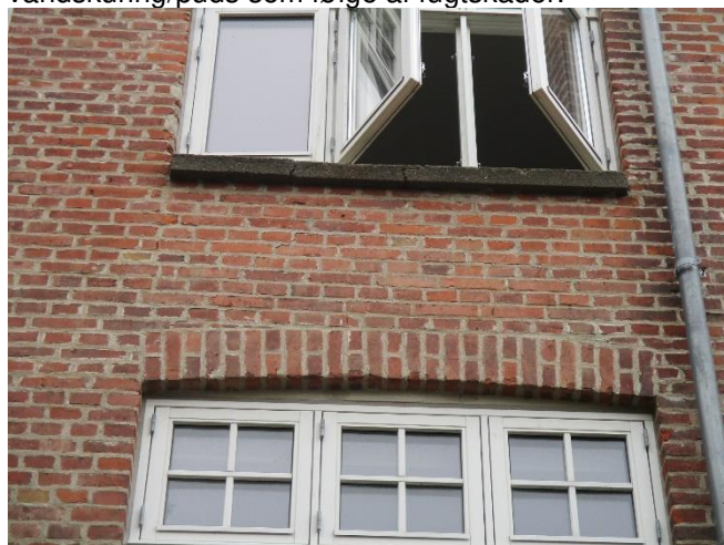
Facade mod gård med revner i murværk over stik.
