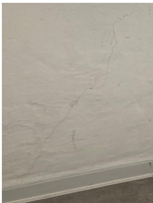
Revne i væg til trappeopgang i nr. 8C
