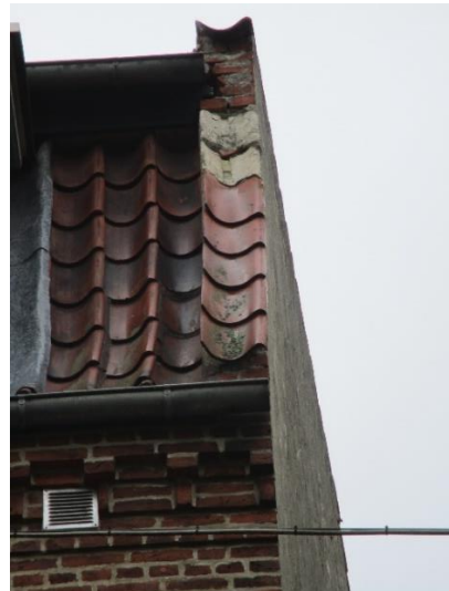
Brandkam med teglstensafslutning. Bemærk at nogle tagsten mangler.
