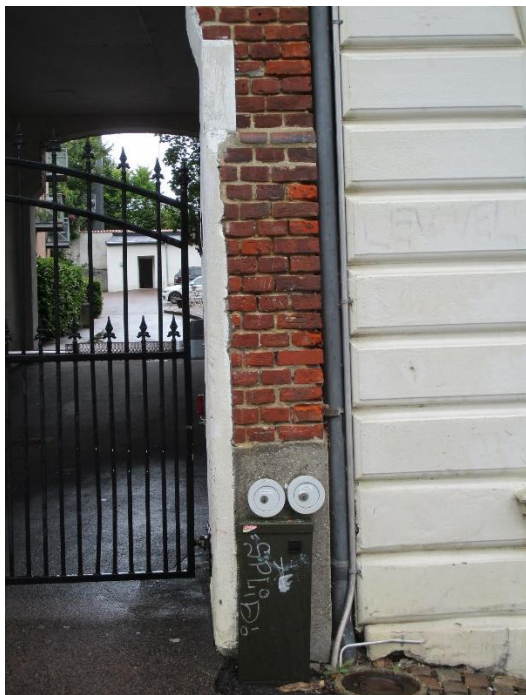
Facademurværk ved siden af port mod nr. 6 med væsentlige nedbrudte fuger og fugtskadede mursten
