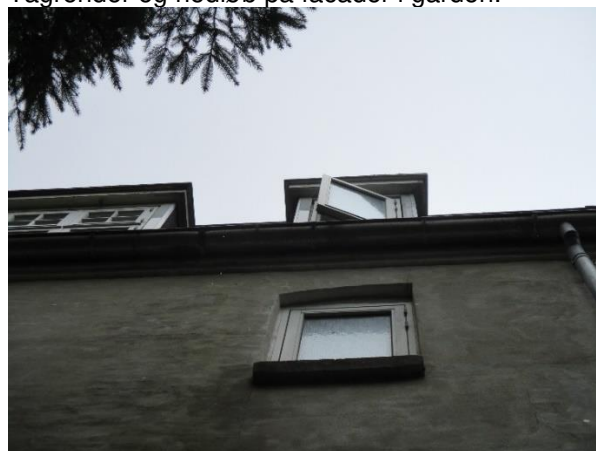
Tagrende og nedløb på facade mod smøgen i nr. 8C. Tagrende var tilsyneladende ikke blevet rensat sammen med øvrige tagrender
