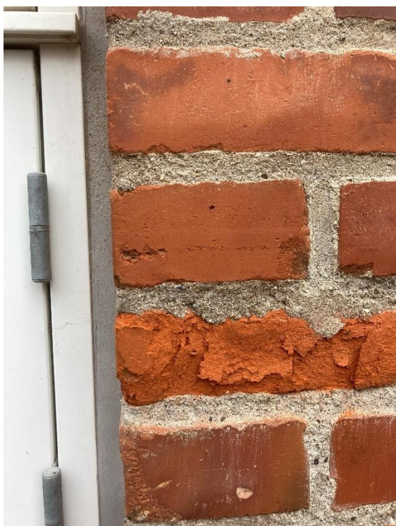
Nedbrudt overflade på mursten
