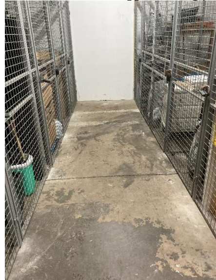
Depotrum i Anneksbygning med støbt fugeopdelt betongulv – uens farveholdning.
