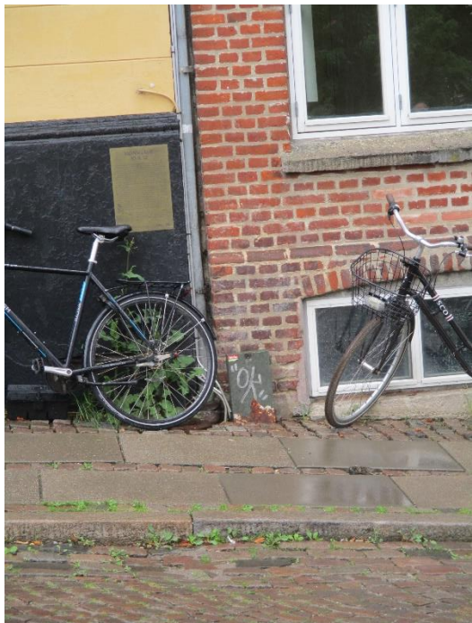
Facademurværk mod nr. 10 med nedbrudte fuger og murværk
