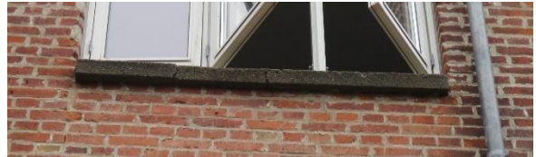
Betonsålbænke under vinduer ses med revner
