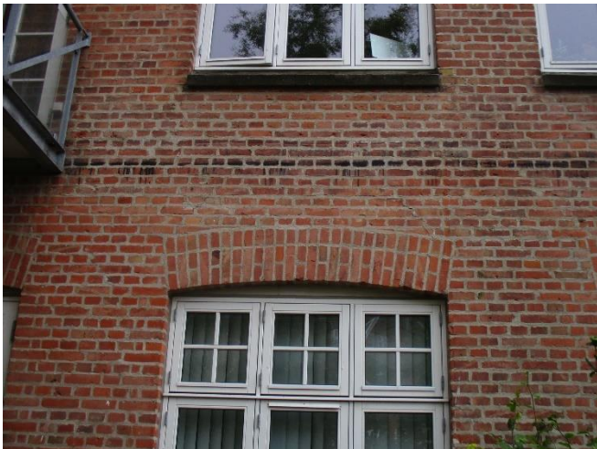
Muret stik med revner i murværk ovenover
