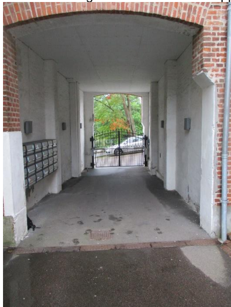
Portadgang med væsentlige og mange afskalninger i vandskuring/puds som følge af fugtskader.
