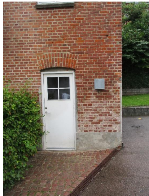
Murværk ved opgang til 8C misfarvet/fugtskadet
