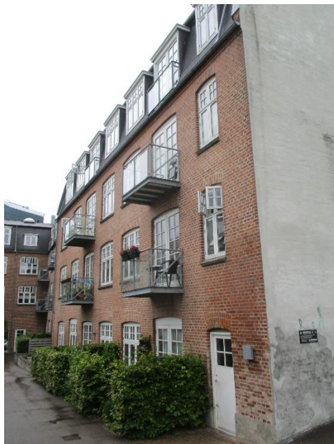
Facade mod gården med vinduer og døre til opgange, altaner og terrasser incl. elastiske fuger fra 2006-07. Bemærk fugtskadedt hjørne, formodentlig som følge af opstigende grundfugt.
