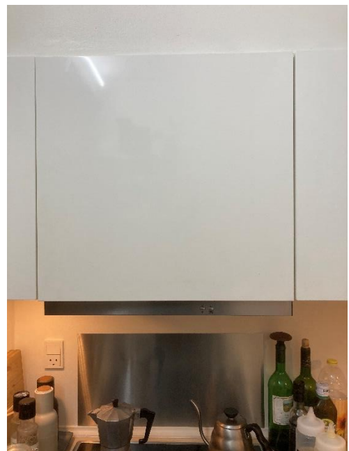
Emhætte i lejlighed i nr. 8A
