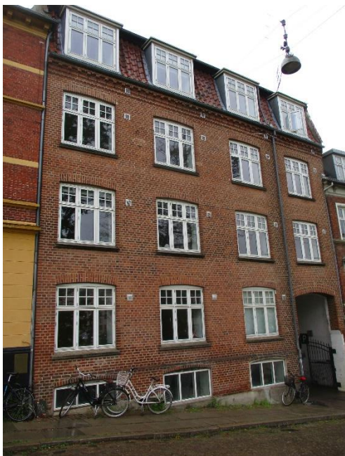
Facade mod Mønsøgade med vinduer og fuger fra 2006 – 07. Bemærk ventiler fra udsugning og skader på især den underste del af facaden.
