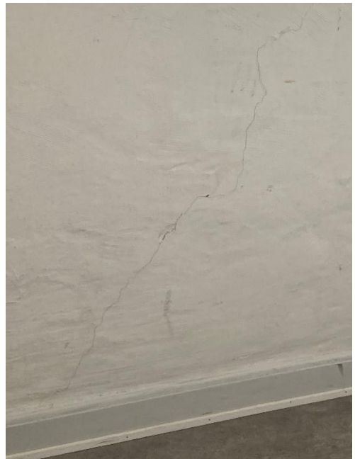
Revne i væg til trappeopgang i nr. 8C
