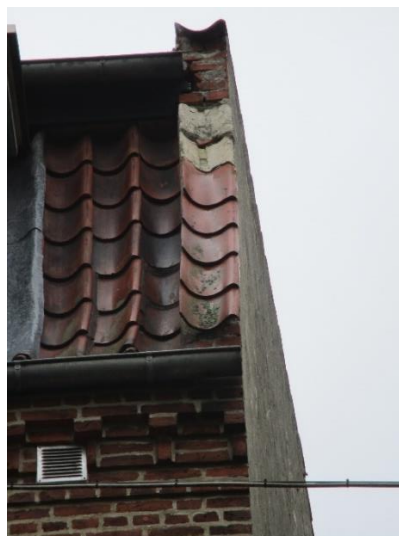
Brandkam med teglstensafslutning. Bemærk at nogle tagsten mangler.
