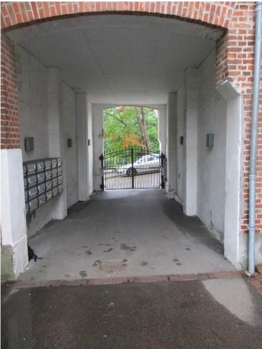
Portadgang med belægning og lineafvanding. Bemærk afskalninger på vandskurede/pudsede vægge efter fugtpåvirkning.
