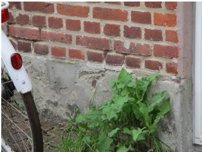
Revnet og afskallet sokkel ud mod Mønsgade
