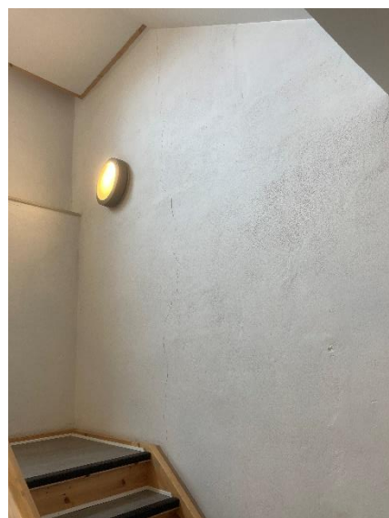
Trappe i nr. 8B med lodret revne ved forkant repos
