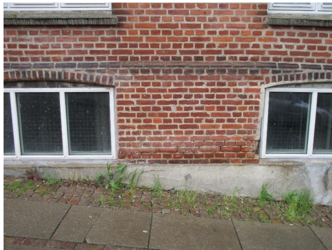
Facademurværk med væsentlig nedbrudte fuger og murværk. Elastisk fuger ved vindue th er sluppet.
