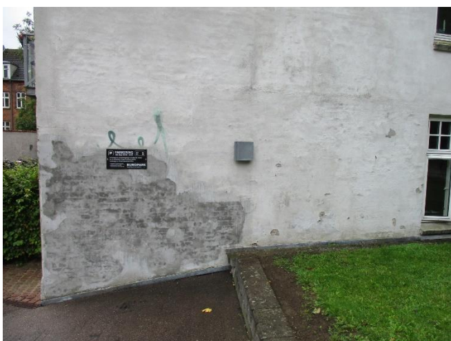
Fugtskadet sokkel og underste vandskuret gavl på nr. 8C
