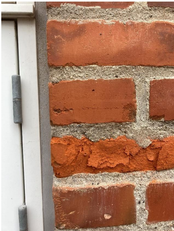
Nedbrudt overflade på mursten
