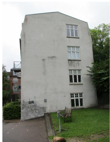
Fugtskadet gavlf med vandskuring af 8C, især på hjørnet mod opgang.
