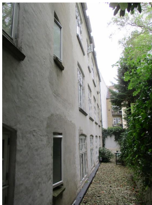
Facade mod smøge med vinduer og fuger fra 2006-07 med afskalninger i vandskuring/puds og misfarvninger
