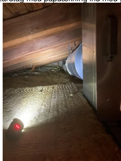
Loftsrum med udsugningsventilator.
