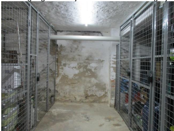
Kældergang med depotrum med væsentlige fugtskadede vægge, formodentlig som følge af opstigende grundfugt.
