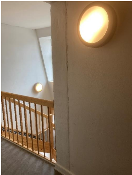
Fuge mellem vægge øverst i trapperum nr. 8B
