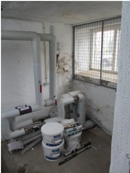
Fjernvarmestik i kælder i nr. 8A
