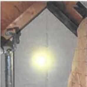
Sjælør Boulevard 28-30- Brandadskillelse på loftet
