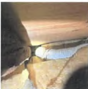
Plastrør gennem etagedæk
