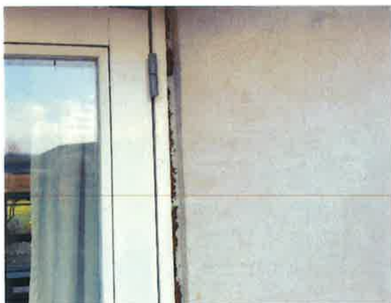
Vinduerne er flere steder ikke fuget
