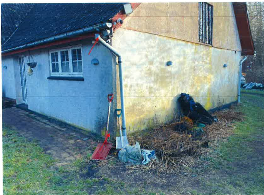
Tagnedløbet er ikke sammenhængende med tagrenden og ydervæggen er tydeligt opfugtet
