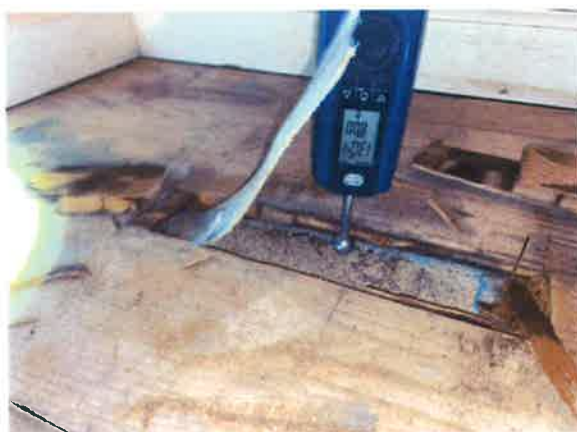
Betongulvet under gulvbeklædningen er kraftigt opfugtet. Kontor
