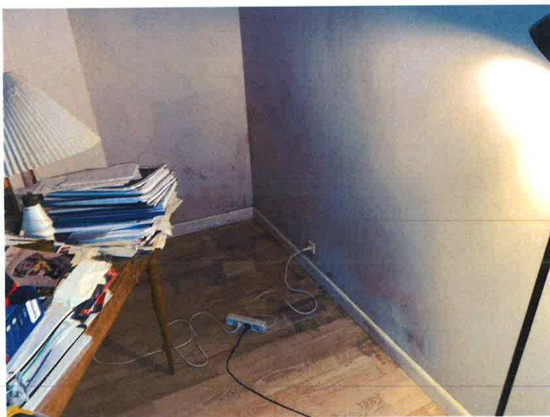
Der ses tydelige tegn på vandskade på gulv og vægge i kontorlokalet. Det er tydeligt at der har været foretaget afvaskning i området.
