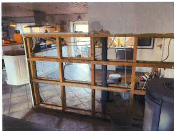
En større del af skillevæggen i køkkenet er demonteret i forbindelse med vandskade
