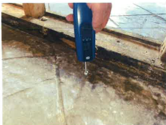
Gulvet måles moderat opfugtet omkring skillevæggen
