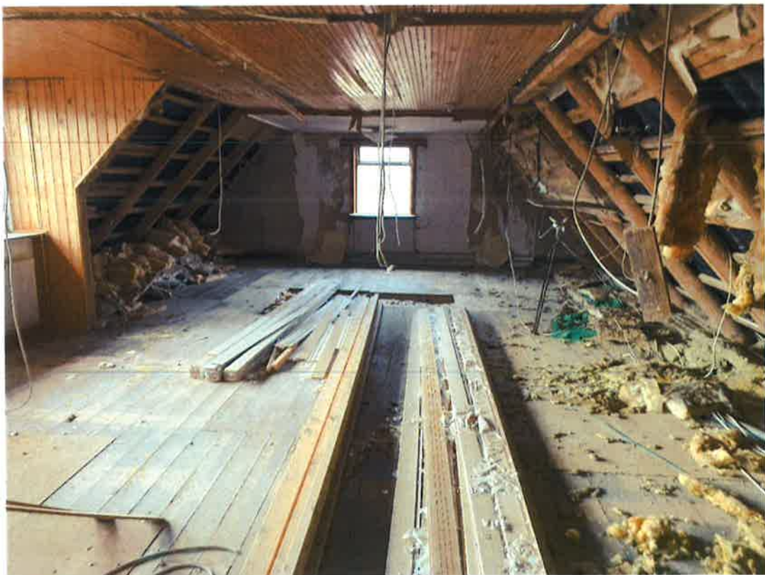
Skråvæggene er demonteret og ledningerne hænger frit uden korrekt sikring mod stød
