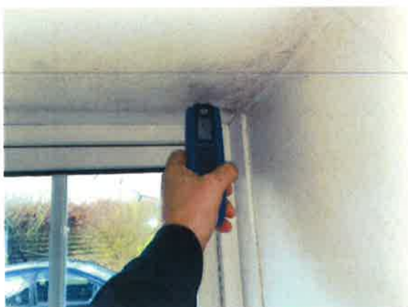
Der ses kraftig vækst af skimmelsvamp i toppen af vindueslysningen. Soveværelse
