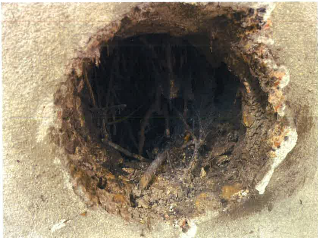
Skorstenen er fyldt med redemateriale. Der er stor risiko for en skorstensbrand.
