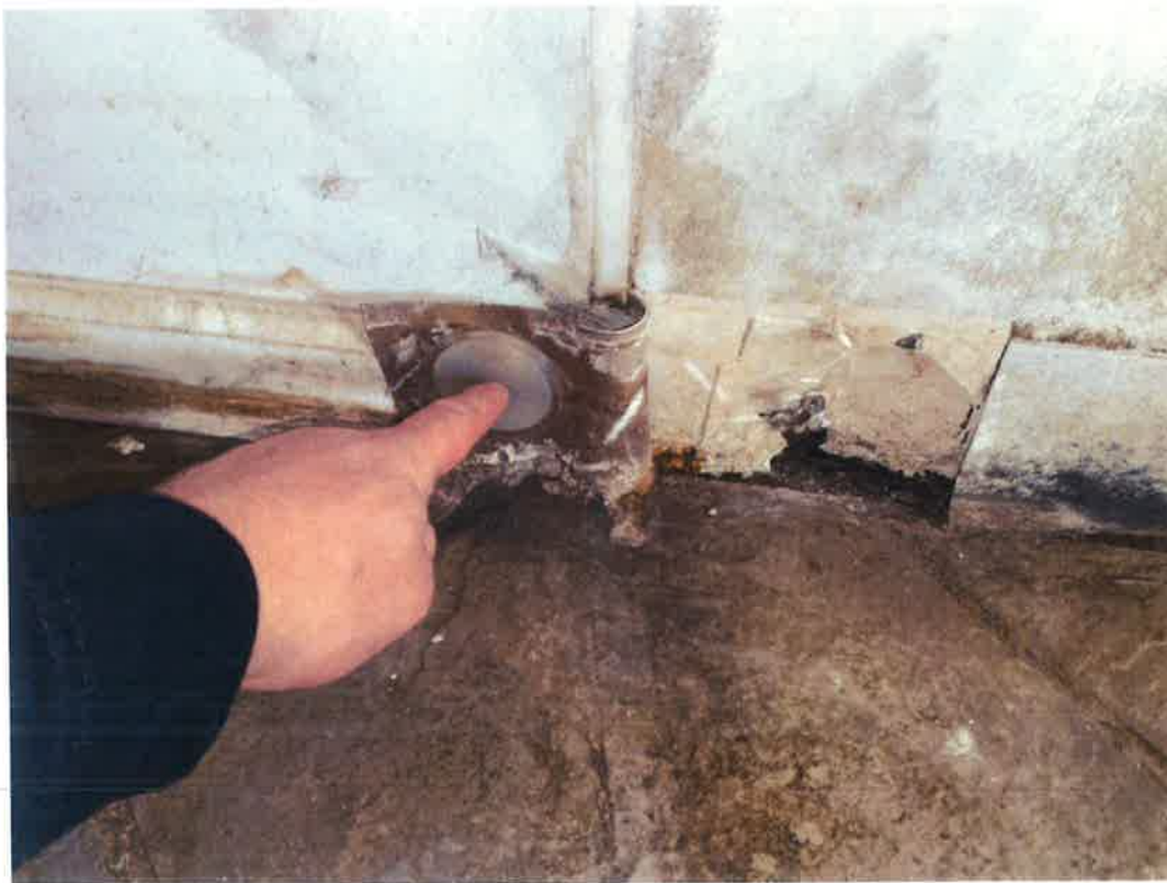
Der ses tydeligt misfarvninger og vækst af skimmelsvamp i området. Prøvetagningssted for aftryksprøve nr. 5. tapet på skillevæg mellem køkken og baggang.
