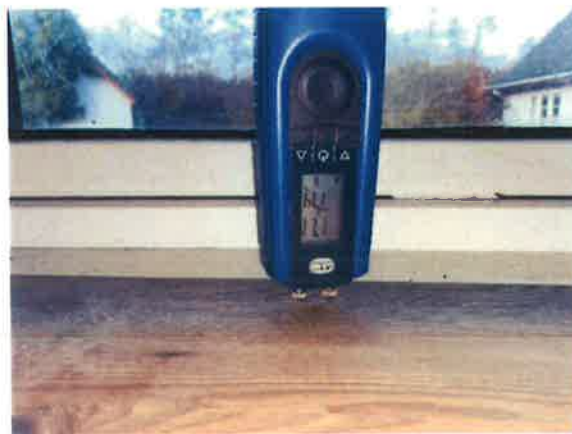
Vindueskarmen er kraftigt opfugtet. Soveværelse
