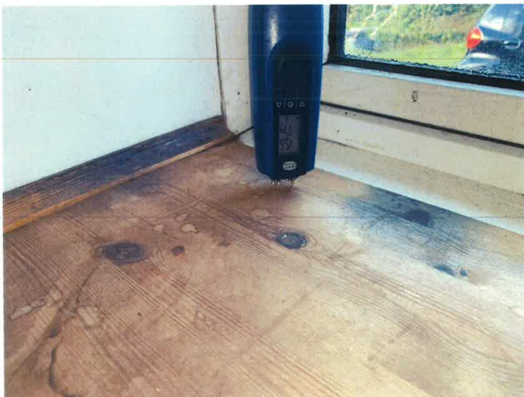
Vindueskarmen og moderat opfugtet og der ses synlig vækst af skimmelsvamp på vinduet og på karmen. Soveværelse.
