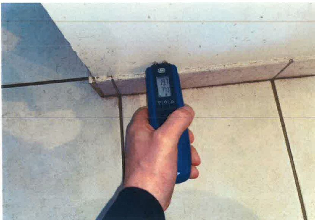
forsatsvæggen er kraftigt opfugtet. Badeværelse
