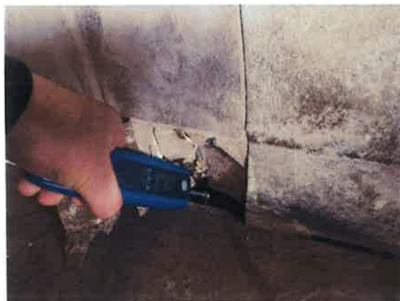
Skillevæggen måles tør i det område hvor der er vandskade i køkkenet. Der ses kraftig vækst af skimmel på tapetet
