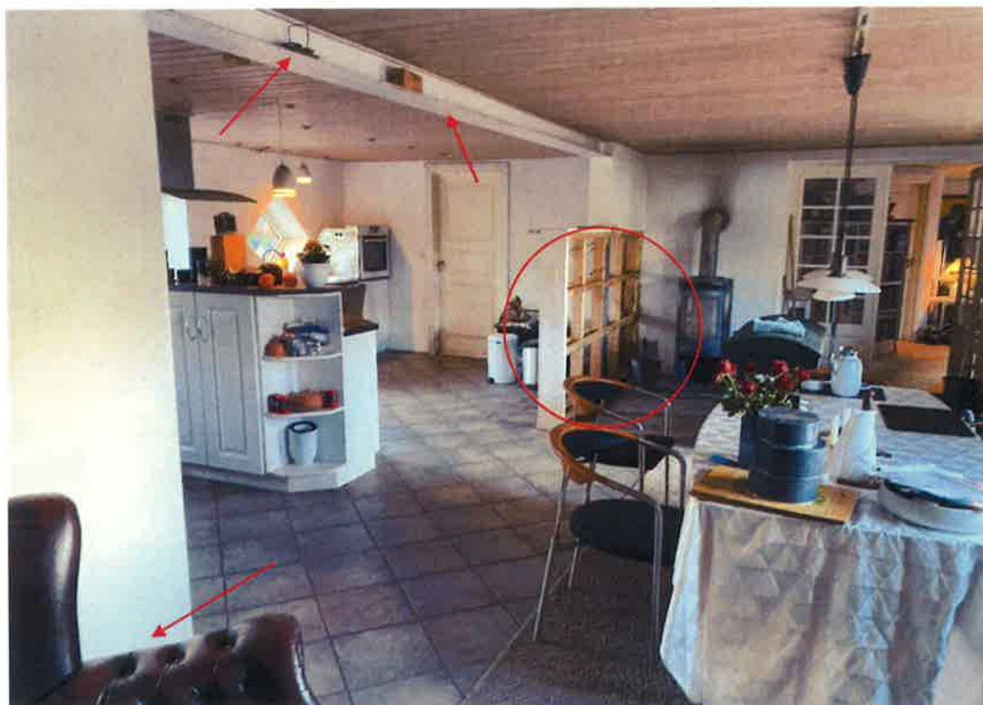
Til højre ses den skillevæg som er delvist demonteret. Til venstre ses den del af skillevæggen som måles kraftigt opfugtet. Det ses tydeligt at jendrageren ikke er brandbeskyttet. Bemærk rottefælden på jerndrageren. Køkken.
