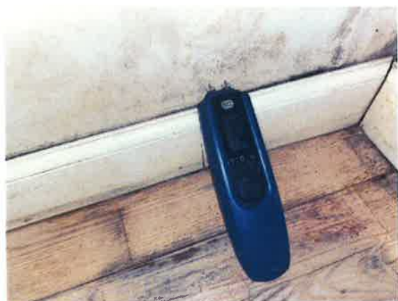
Skillevæggen som er vandskadet i kontoret måles tør
