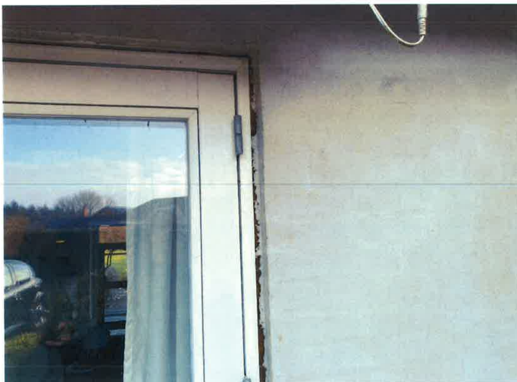
Der mangler fuger om flere vinduer og døre.
