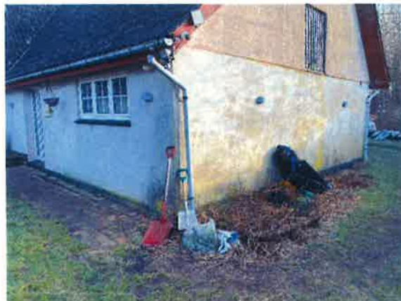
Gavlydervæggen mod syd, ud for soveværelset er tydeligt opfugtet og tagnedløbet sidder ikke fast på tagrenden
