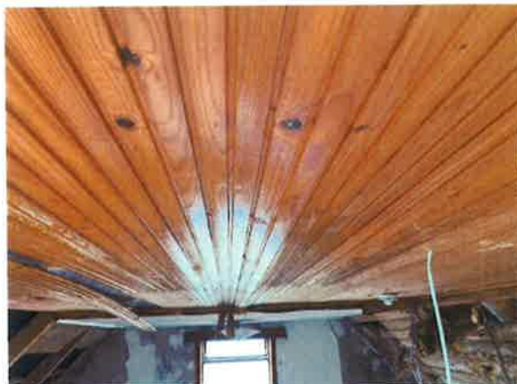
Der ses flere tegn på vandindtrængning på loftet på 1. salen. Loftsbeklædningen er deformeret og der ses synlig skimmel på loftet.
