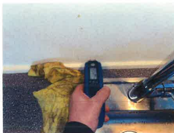
Forsatsvæggen måles moderat til kraftigt opfugtet i køkkenet
