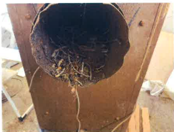
Der ses redmateriale i fyret og i skorstenen
