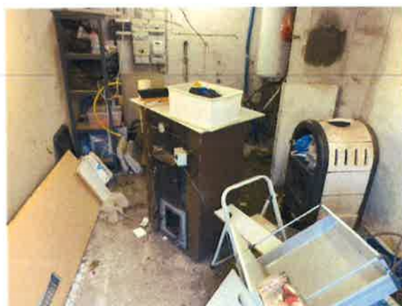
Fyret er frakoblet. Det er ikke muligt at opvarme huset
