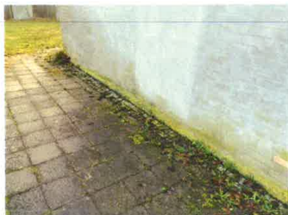
Ydervæggene bærer generelt præg af at være opfugtede
