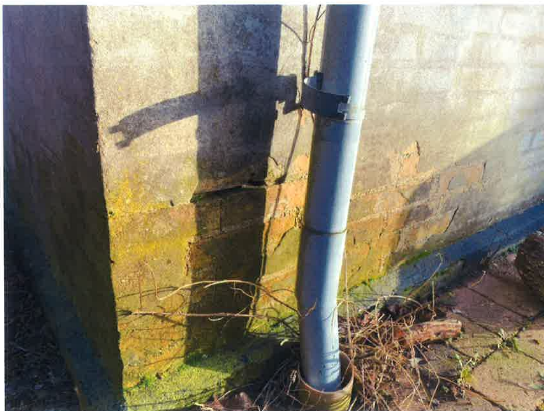
Murværket er tydeligt opfugtet omkring tagnedløbene. Der er fri adgang for rotter til kloakken.
