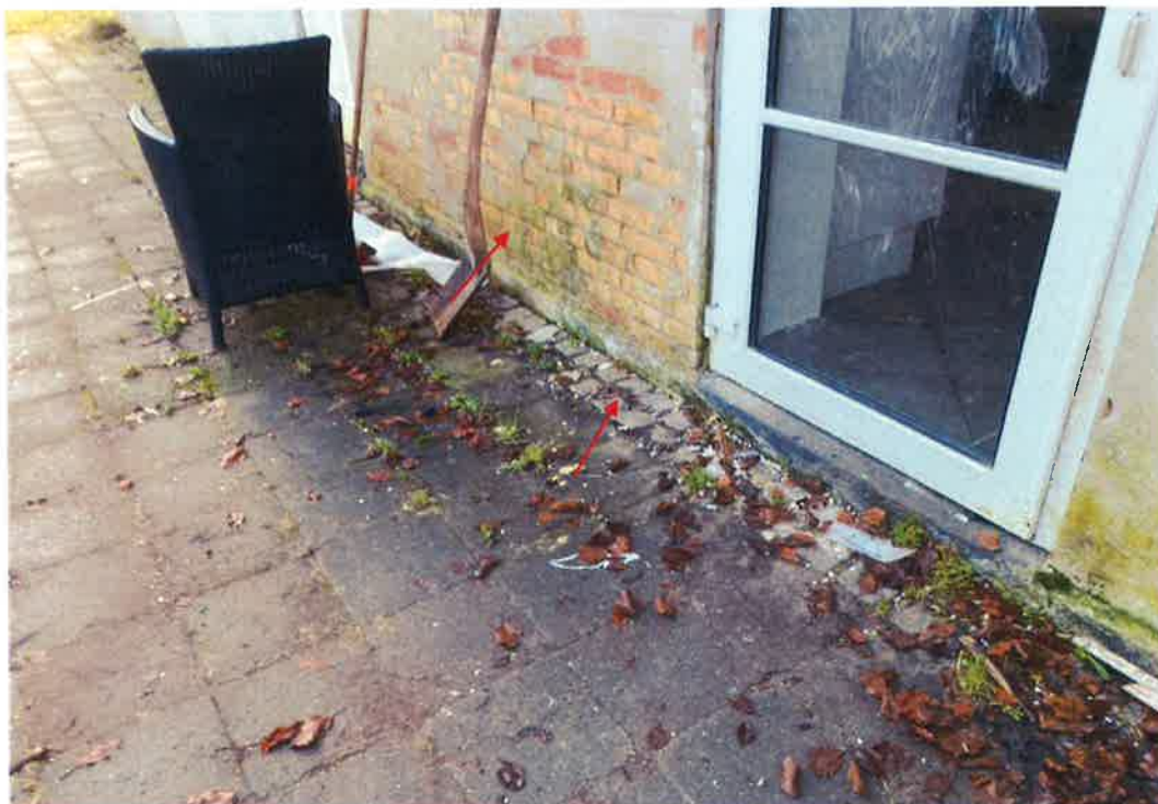
Der er for lille afstand mellem flisebelægning og murværket. Murværket ud for køkkenet er så opfugtet at pudslaget ikke kan hæfte på murværket.
