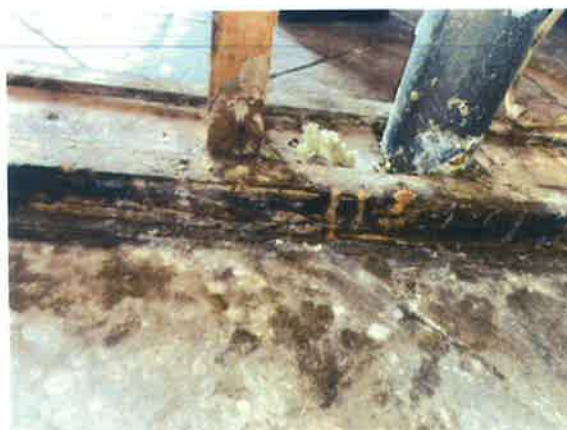
Der er kraftig vækst af skimmelsvamp på træskelettet og bundremmen er rådnen
