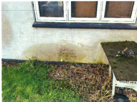
Fugtplet ud for det sted hvor der laves destruktivt indgreb i forsatsvæggen i stuen
