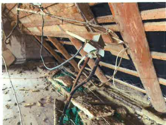
Ledningsnettet hænger løst på 1. sal
